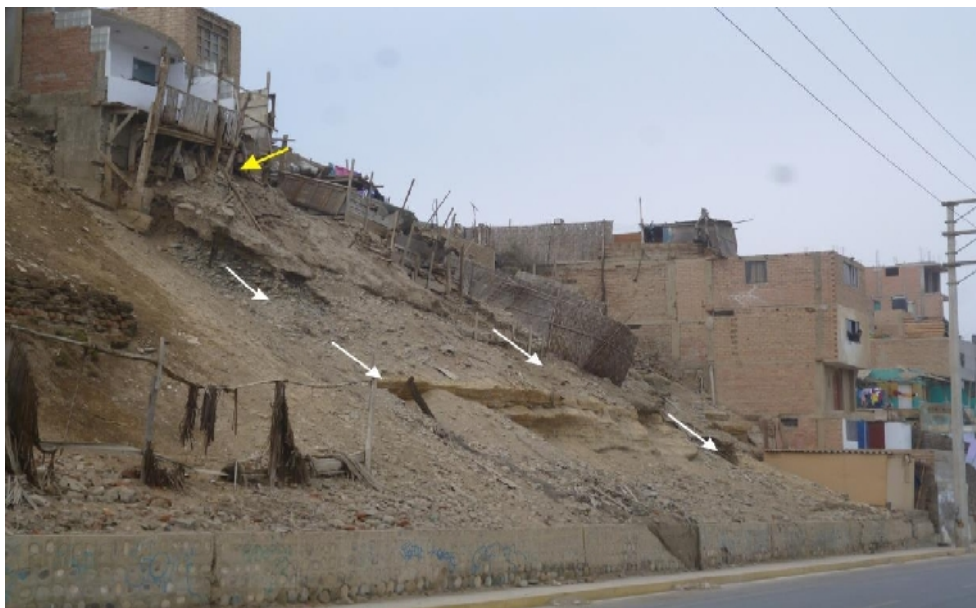
Figura 38: Zona de alta susceptibilidad a la ocurrencia de derrumbes (flechas en blanco). Las flechas de color amarillo indica la zona de apuntalamiento de viviendas.
