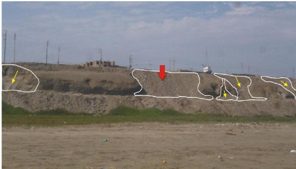
Figura 37: Derrumbes en taludes conformados por depósitos aluviales. Ellos se encuentran en el límite de los distritos de Caleta Carquin y Huacho.
