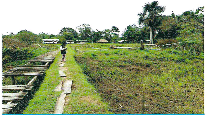
Proyecto de levantamiento de rasante y puente, ambos deteriorados
