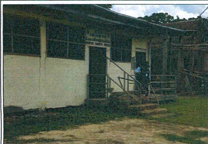
Identificación de la afectación del colegio inicial a causa del temblor ocurrido en la zona. Anteriormente el colegio era una construcción adaptada a la inundación.
