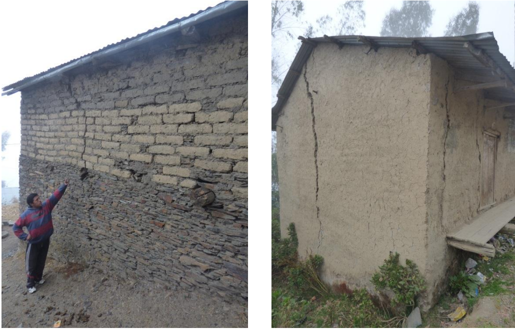
Foto 1. Viviendas con paredes fisuradas.
