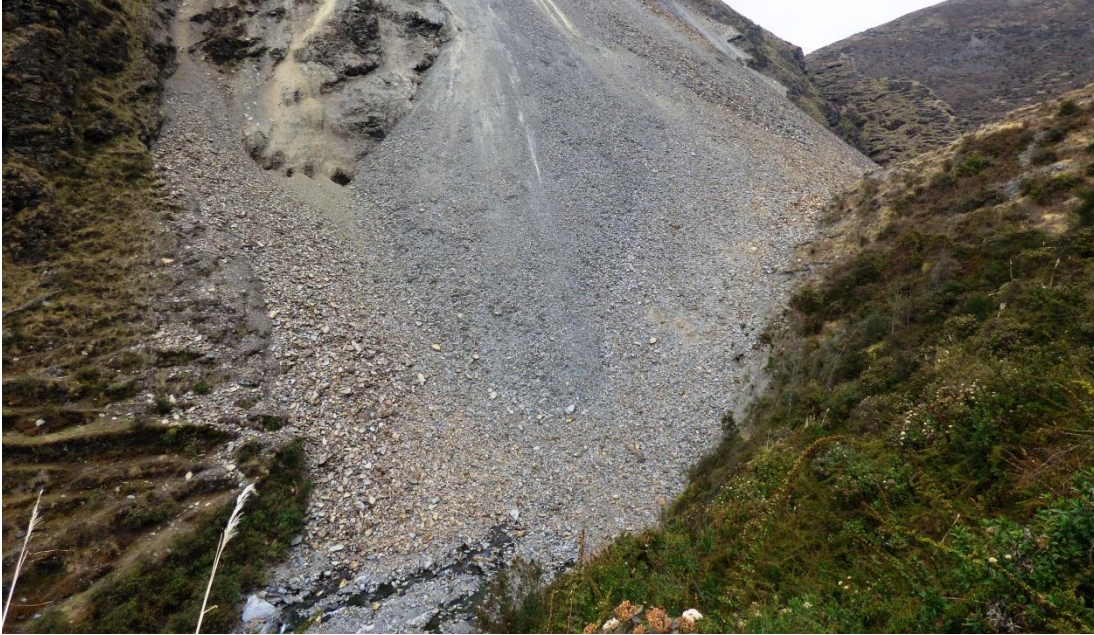
Foto 17. Filtración del agua del río Jarahuaña por debajo del derrumbe. Vista aguas arriba.
