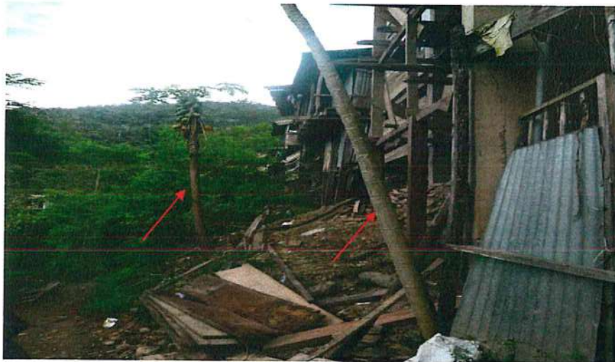
Figura 17. Viviendas afectadas en el caserío de Arco Punco, se observan plantas de papaya inclinadas producto del asentamiento del terreno
