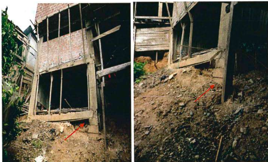
Figura 16. Cimientos de las viviendas afectados por el asentamiento del terreno
