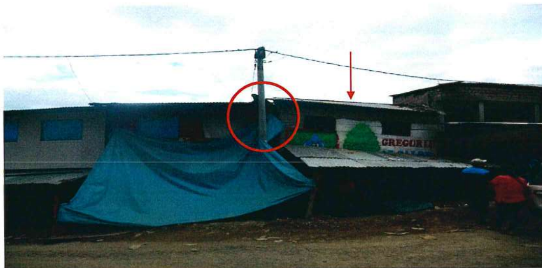
Figura 21. Viviendas afectadas, se observa la inclinación de la vivienda. Cabe mencionar que el poste de alumbrado público podría ser afectado
