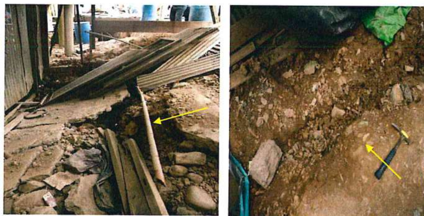
Figura 19. Daños generados por el basculamiento y agrietamiento del terreno, ocasionados por el empuje de la masa inestable, característica típica de un deslizamiento rotacional. La flecha indica la dirección del movimiento de la masa inestable
