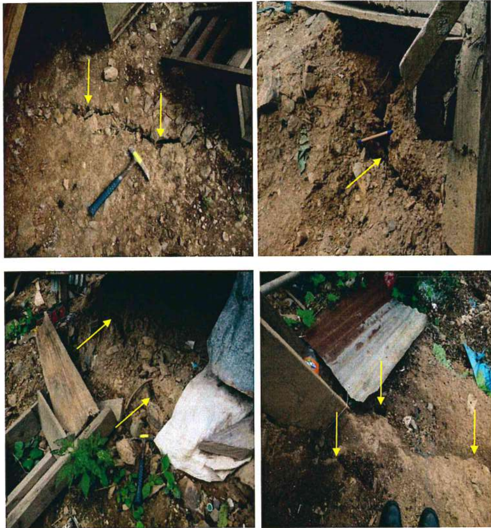
Figura 15. Se identificaron agrietamientos en el terreno que afectan cimientos de las viviendas, también se observaron asentamientos en el terreno
