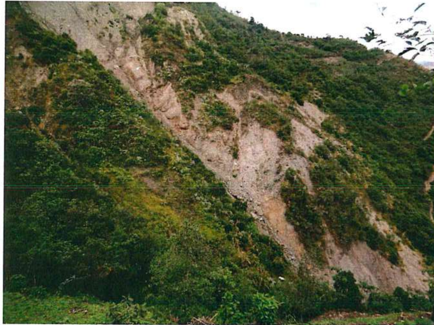
Fotografía 8. Derrumbes identificados en las laderas del cerro Sillapata (margen izquierda de la quebrada Ispingol). Vista al sur
