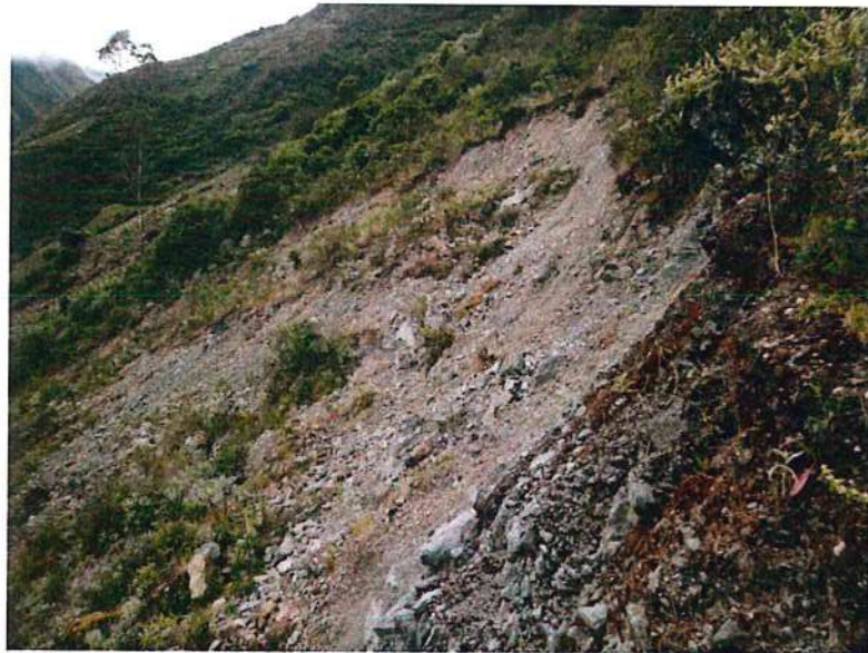
Fotografía 5. Deslizamiento rotacional identificado en el cerro Sillapata, en la margen izquierda de la quebrada Ispingol. Vista al noreste
