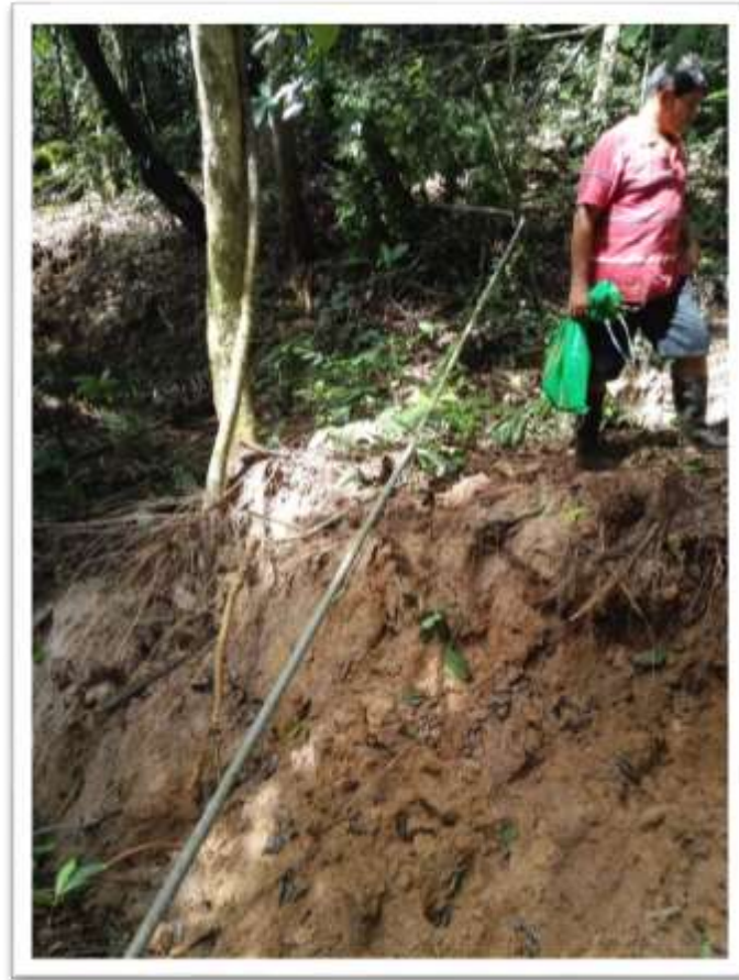
Foto N° 6: Tubería de agua de 1 pulgada de diámetro, en un escarpe con 2 m de desnivel.
