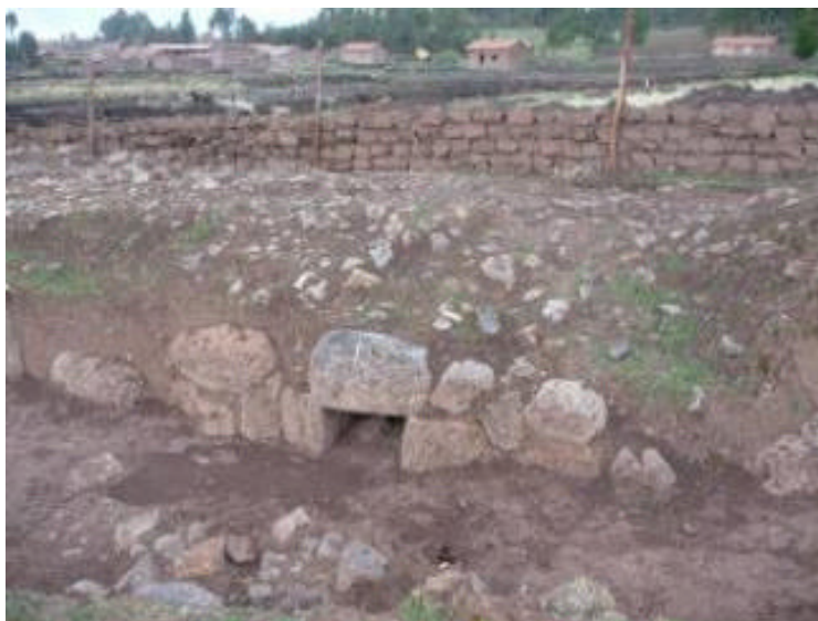
Foto 18. Canal de rebose de aguas.
