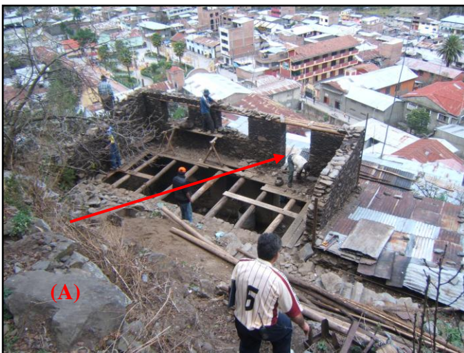
Foto 12.- Reconstrucción de vivienda, que fue destruida en la última caída de rocas. Se observan los bloques dejados en la última caída de rocas (A). La flecha indica el sentido de la trayectoria del desplazamiento de los bloques.
