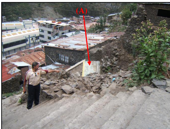
Foto 6.- Antiguo muro de contención que fue destruido por la última caída de rocas (26 de enero del 2006).
