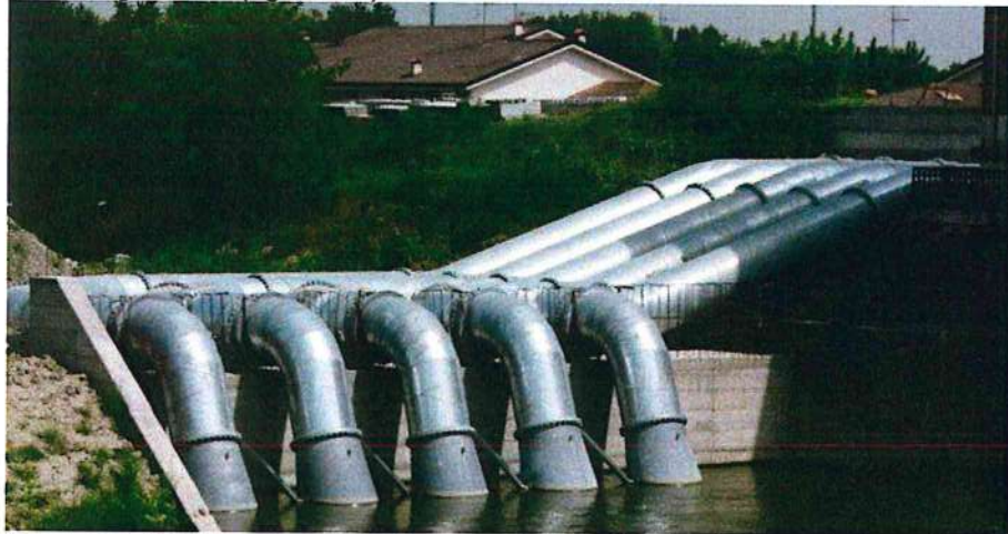
Figura 38. Válvulas de regulación para distribución de agua a vertederos finales. Fuente: xylem.com (2019).
