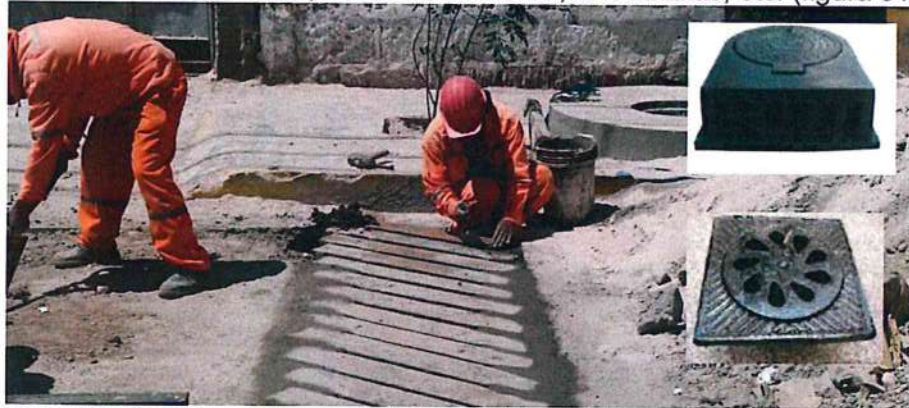
Figura 34. Sumideros y bocas de tormenta. Fuente: Magtel.es (2016).
