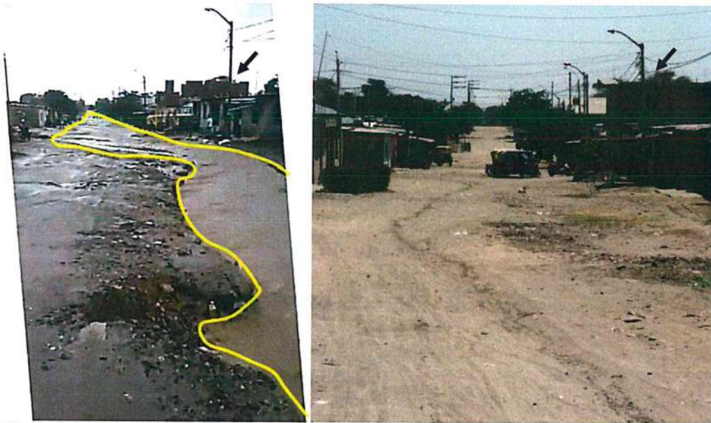
Figura 20. Zonas de fuerte erosión debido al agua de escorrentía que luego fue depositada en las calles Sáenz Peña y 13 de Diciembre.
