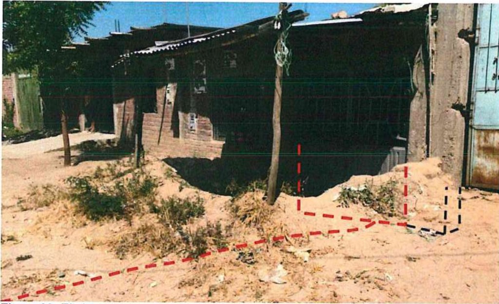
Figura 33. El piso o nivel de la vivienda ha quedado 50 cm por debajo de la superficie de la calle.
