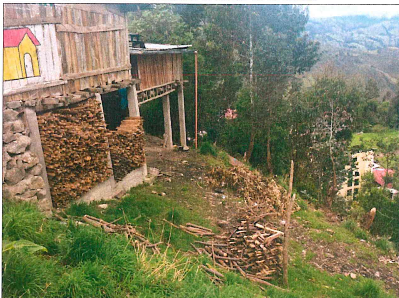
Foto 11: Casas cimentadas al borde de la ladera
