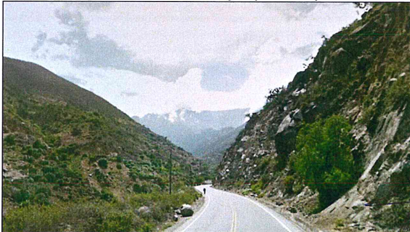
Ilustración 9: Se observa las laderas muy empinadas al pie de la carretera
