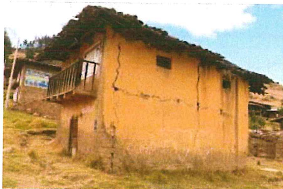
Fotografía N°02: Viviendas en estado precario
