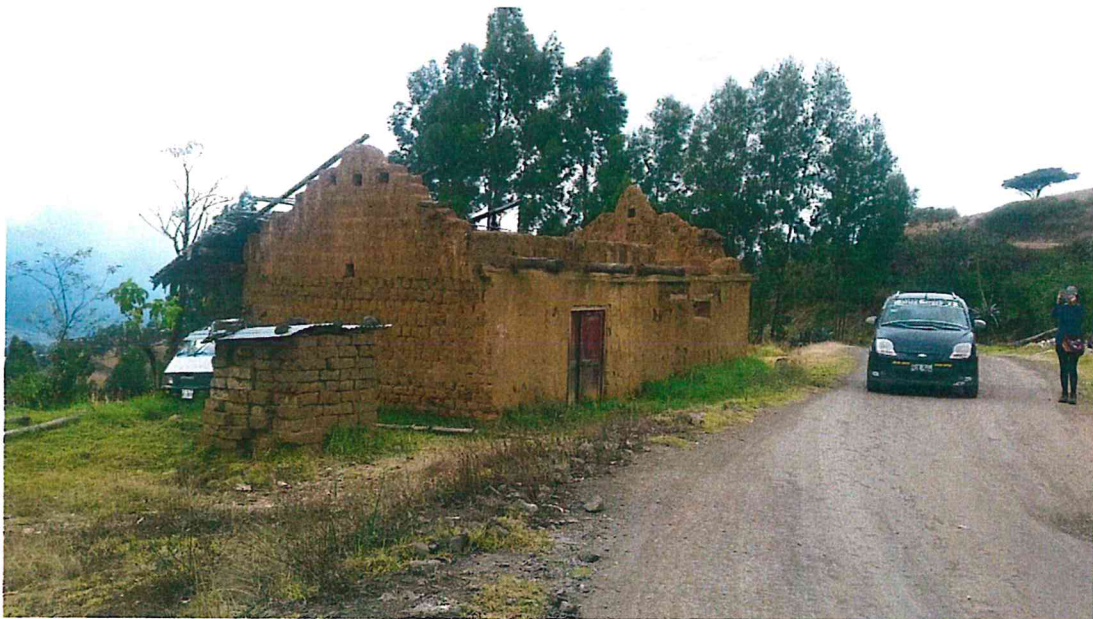
VISTA DE VIVIENDA COLAPSADA
