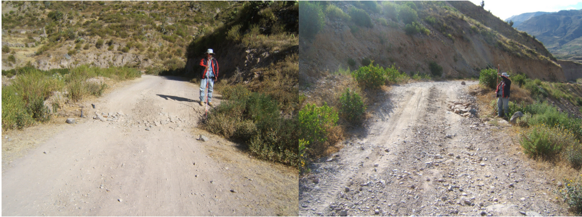
Foto 9. Asentamientos en la plataforma de la carretera; cuerpo del deslizamiento del cerro Antahuilque.
