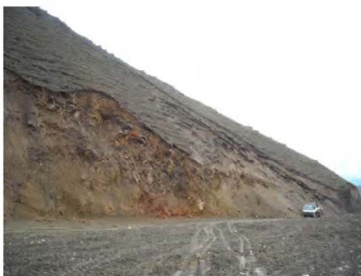
Figura 5: Formación de deslizamientos debido al corte de talud y ampliación de la carretera Calca-Lares
