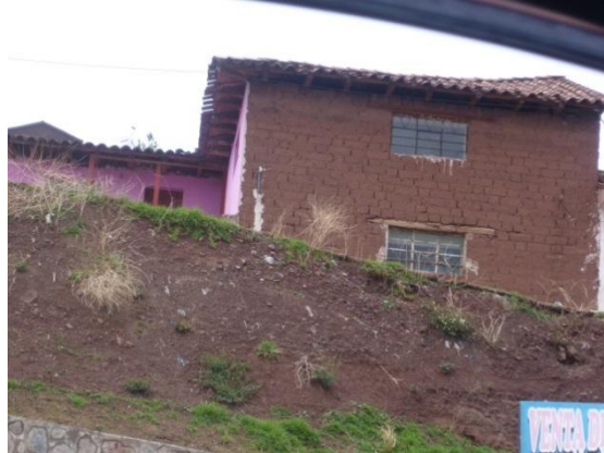
Figura 39. Edificaciones de adobe de dos niveles con uso destinado a vivienda. No existe ningún refuerzo vertical ni horizontal y el aparejo de la mampostería de adobe es deficiente.
