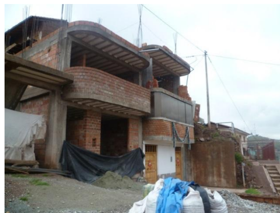
Figura 38. Edificaciones de mampostería de dos niveles. Regular estado de conservación. Uso destinado a vivienda.
