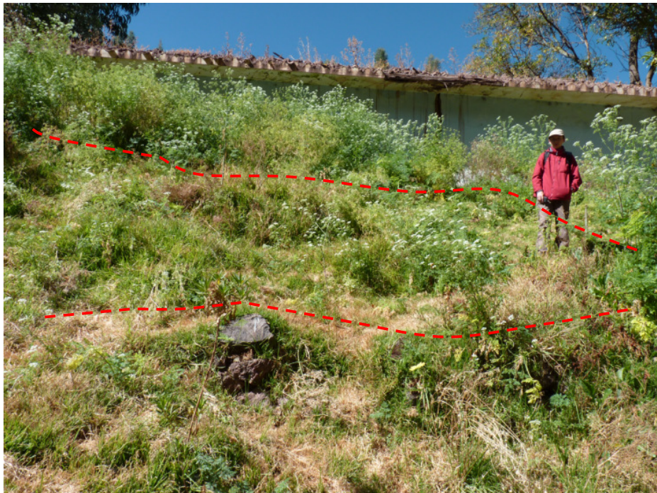
Grietas de tensión cubiertas por vegetación en la parte posterior al Centro Artesanal. Estas se deben a la liberación de esfuerzos frente al cambio de pendiente.
