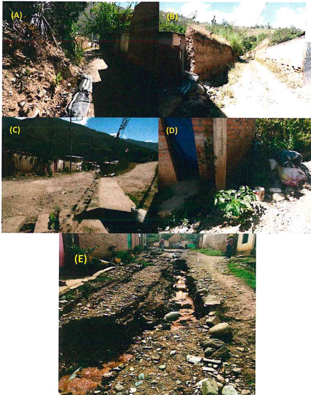
Figura 13: Zonas por donde paso el huayco de la quebrada Retamayoc; (A) Calle por donde pasa el canal foto con direccion oeste. (B) Calle por donde pasa el canal foto con direccion este. (C) Cruce de la vía carrozable con la canalizacion de la quebrada. (D): Comienzo del Jr. La Zanja, donde la canalización pasa por debajo de las viviendas. (E) El Jr. La Zanja por donde bajo el huayco a principios de año, esta foto fue tomada por personal de la Municipalidad de Tomaykichwa.
