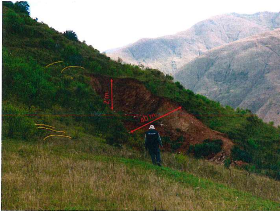
Figura 22: Deslizamiento rotacional evaluado ubicado en la margen izquierda de la quebrada Ishla con escarpa de 2 m, ancho de 40 m y con grietas tensionales alrededor de color amarillo.
