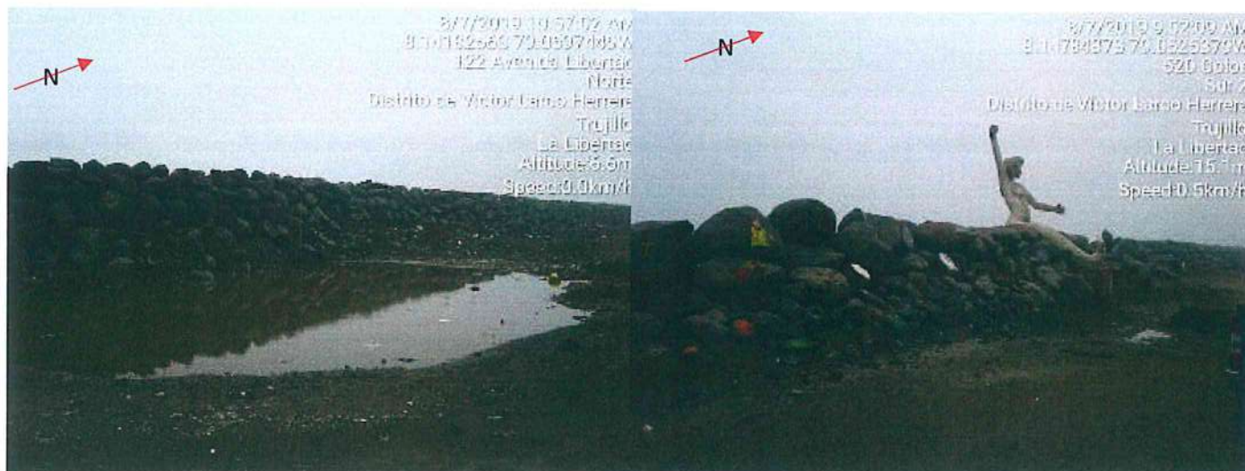
Figura 21. Evidencias de empozamientos de aguas marinas por choque de olas en el enrocado, identificados a inmediaciones de la Av. Libertad (vista izquierda) y Av. Soane (vista derecha) con intersección con calle Colón. Fuente: Elaboración Propia 2019
