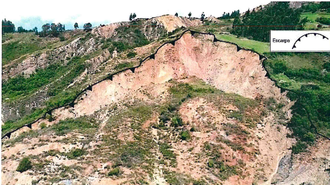
Foto 05: Vista del deslizamiento activo. Nótese la escarpa principal con 450 m de longitud.
