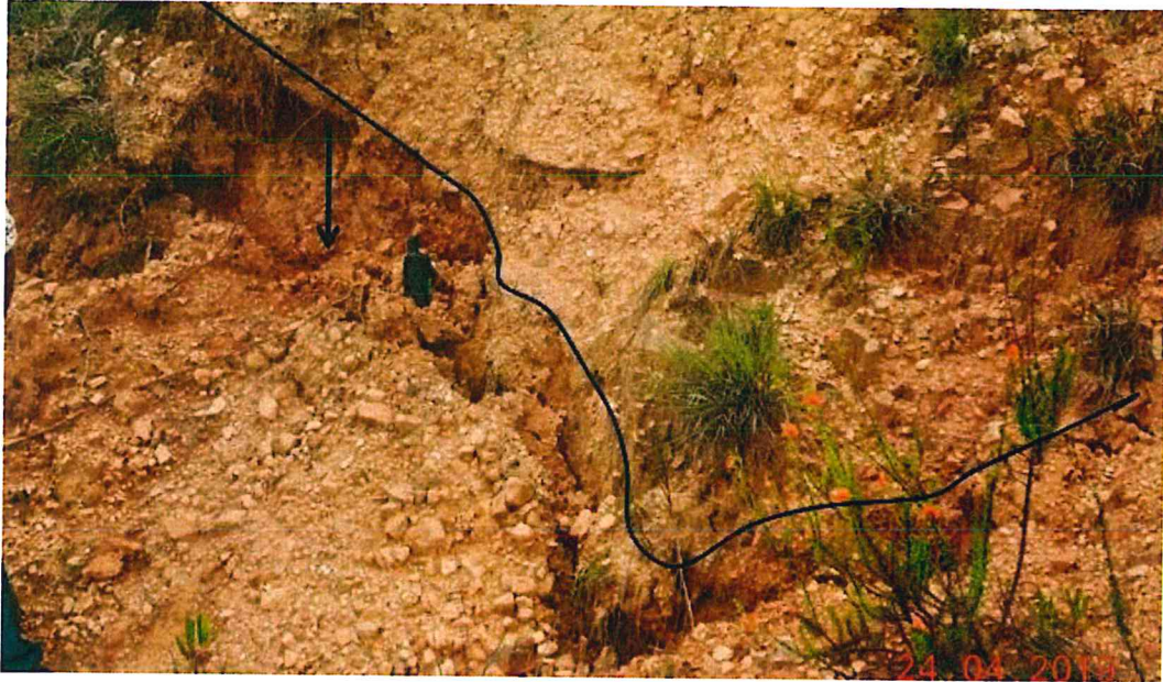
Foto 12: Agrietamientos y asentamientos detrás del escarpe principal.
