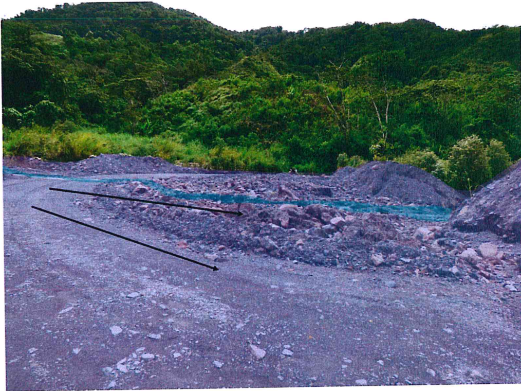
Figura 21. Tramo de carretea afectada por flujo de detritos en el sector Huampuyo.
