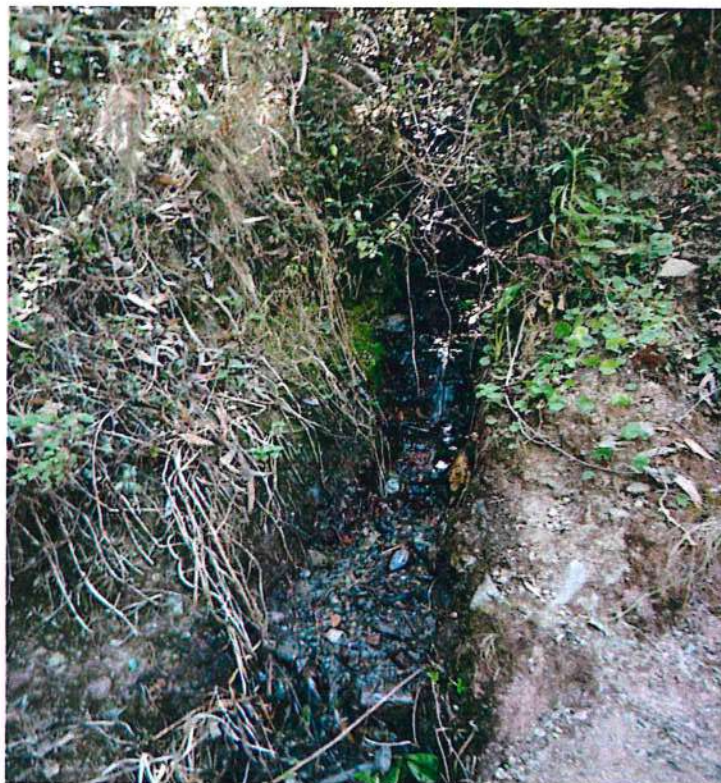
Fotografía 9. Se observó afloramientos de aguas subterráneas (manantes de agua), que está saturando el suelo. Se aprecian canales sin revestimientos.
