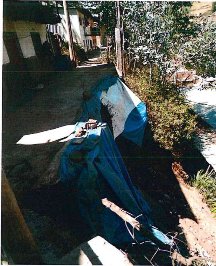
Fotografía 6. Se observó el colapso del material (cemento combinado con arena) que pusieron los vecinos, para mejorar la vía peatonal, genero sobrecarga que afecto a viviendas metros abajo.
