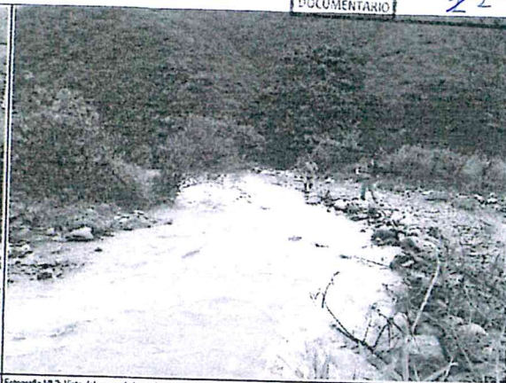
Fotografía N°2: Vista del cause de la quebrada Marta aguas abajo erosionada y colmatada afectando parcelas agrícolas en el sector "El Huabo".
