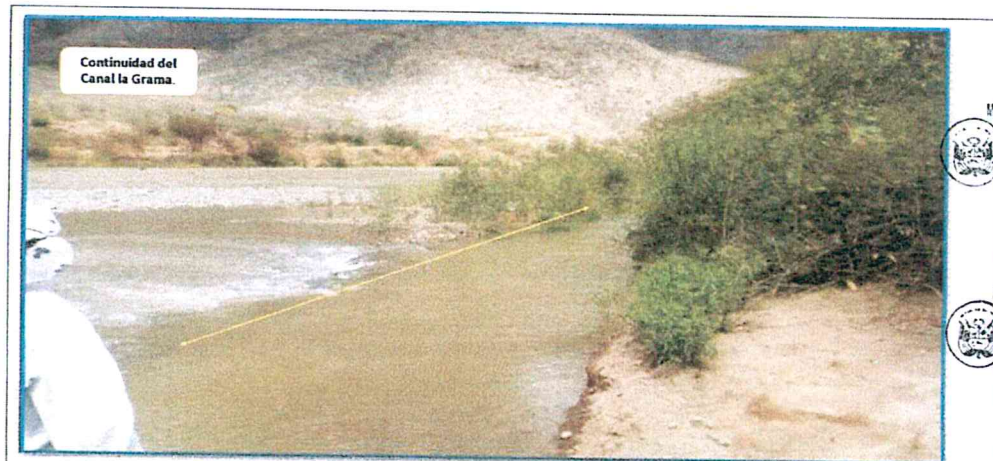
Fotografía N°01: En esta vista se aprecia el cauce colmatado del río Huancabamba, donde podemos apreciar bastante vegetación en el cauce y de la bocanoma del canal lateral la Grama, donde se recomienda descolmatar su cauce y colocar un enrocado en su caja hidráulica de la bocanoma.
