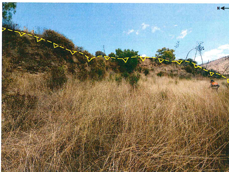
Figura 8. Vista de la primera escarpa de deslizamiento antiguo reactivado cubierto por vegetación, se ha marcado con líneas de color amarillo el trazo de la escarpa
