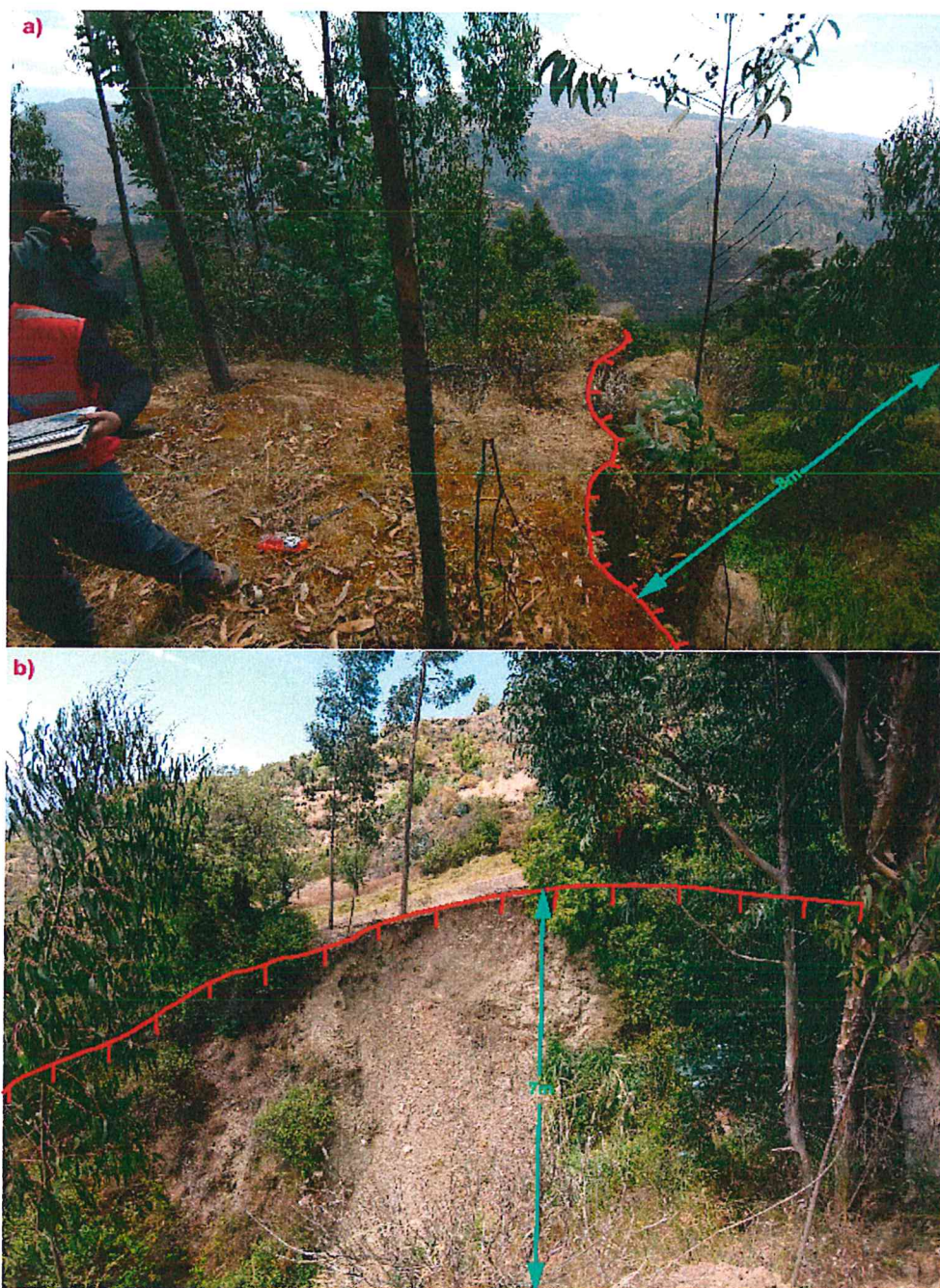
Figura 15. a) Margen izquierda de la quebrada en donde se delimitó la escarpa de derrumbe con líneas de color rojo, tiene un ancho de 8 m, se observa algunos árboles inclinados b) margen izquierda del derrumbe, tiene una profundidad de 7m.; compuestos de esquitos del Complejo Marañón. Se encuentra en las siguientes coordenadas UTM 342307 E, 8846583 N con cota 3147 m.s.n.m.
