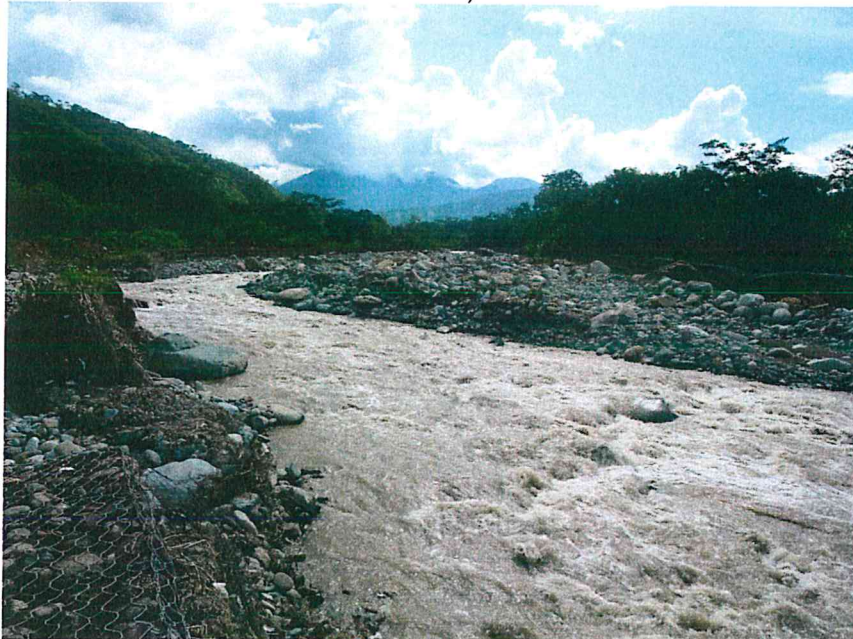
Fotografía 8 Margen izquierda del rio Santa Rosa, se observa la estructura (defensa ribereña), presenta forma sinuosa por la fuerza del caudal, también se puede observar que el caudal se encuentra colmatado por material fluvial
