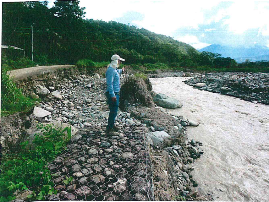
Fotografía 9. Vista tomada con dirección suroeste en la coordenada UTM 637208 E – 8596642 S, por la crecida del caudal de río Santa Rosa, afecta la defensa ribereña formada por gaviones, también afecta 80 m de tramo de vía afirmada.
