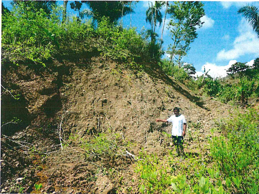
Fotografía 02. Se observa corona de deslizamiento con salto de 3 a 5 m
