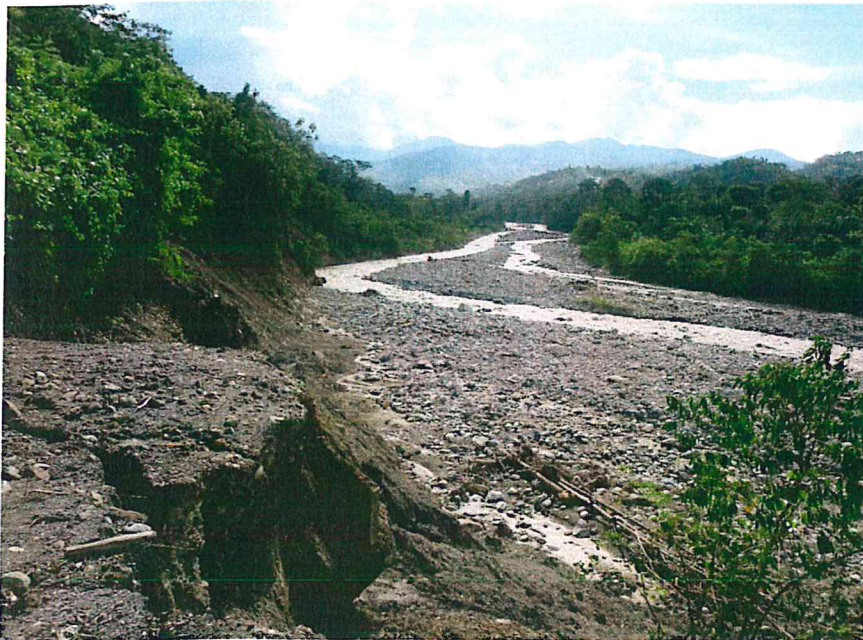
Fotografía 10 Vista tomada con dirección suroeste en la coordenada UTM 636502 E – 8596197 S, es afectado por erosión fluvial, también por derrumbes que se originan en el talud superior de la vía afirmada. Al fondo de la fotografía se observar que el cambio de curso del caudal erosiona la margen derecha del río Santa Rosa
