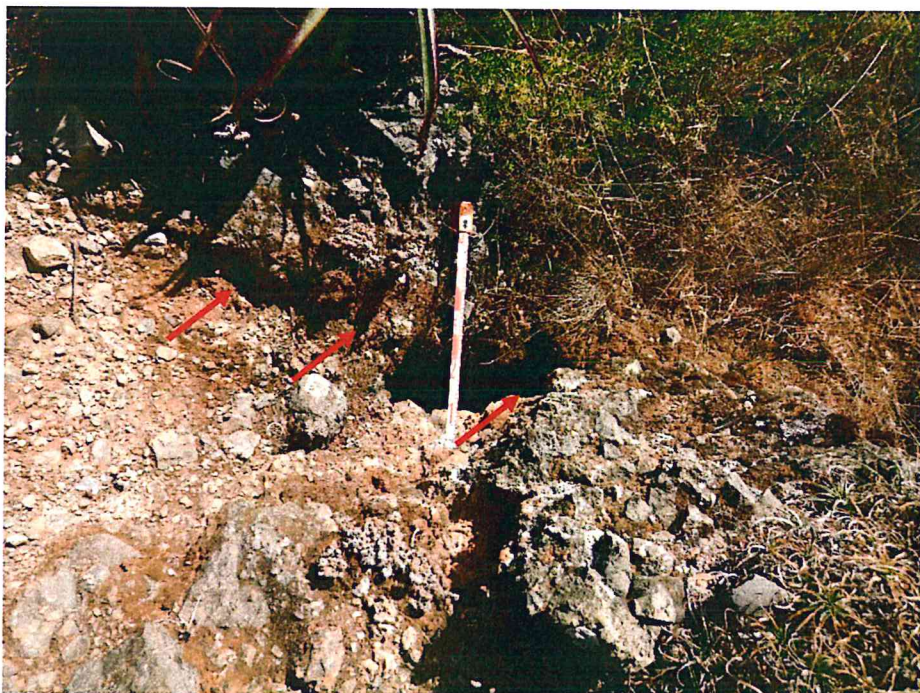
Figura 14. Agrietamientos longitudinales a los escarpes principales, ubicados dentro de la masa deslizada, con profundidades de hasta 1 m y separación de hasta 10 cm. Vista al este
