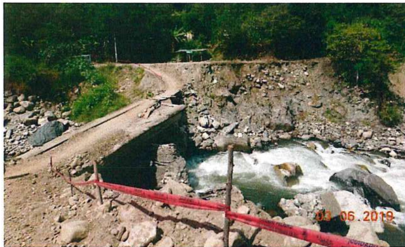
Fotografía 18. Vista del puente Iyape colapsado a partir del huaico que se generó en noviembre del año 2018.
