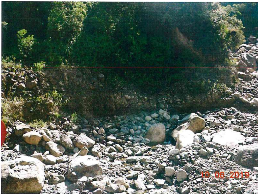
Fotografía 25. Erosión fluvial en la margen derecha de la quebrada Alfamayo
