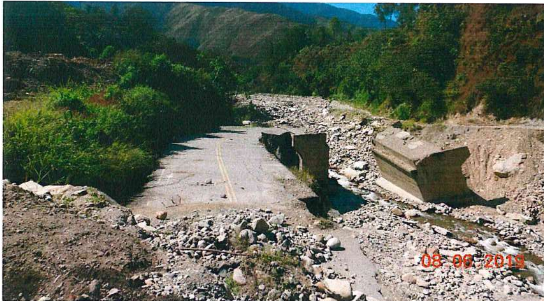
Fotografía 22. Puente colapsado producto de la erosión que generó el flujo de detritos.
