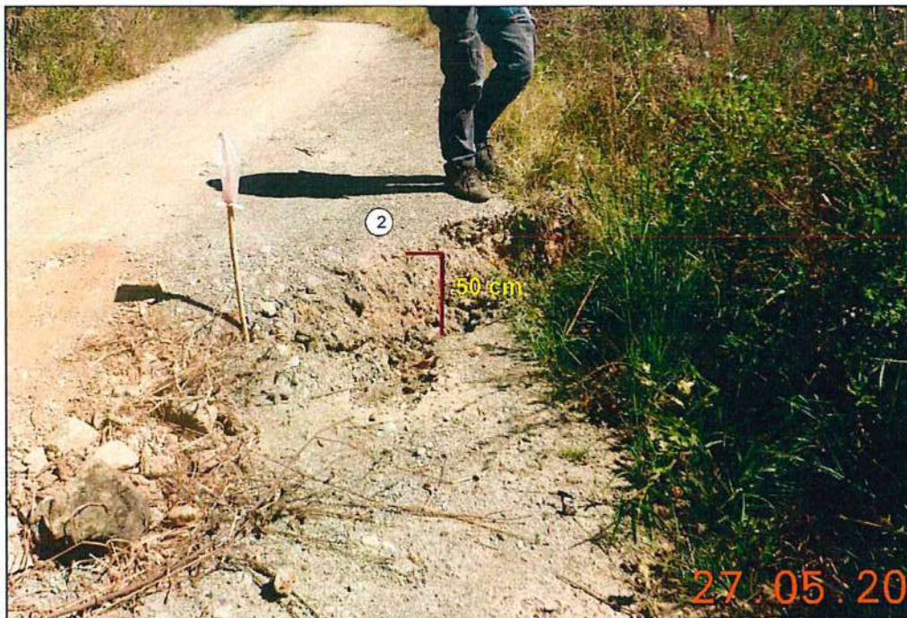
Figura 19. Vista del desplazamiento en el camino carrozable que conduce a pueblos aledaños.
