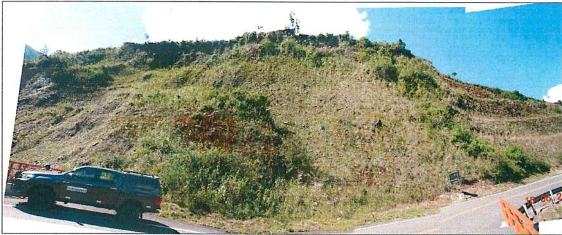
Figura 39. Deslizamiento antiguo reactivado, así mismo se observa terraseo, el cual atenúa el proceso de reactivación.
