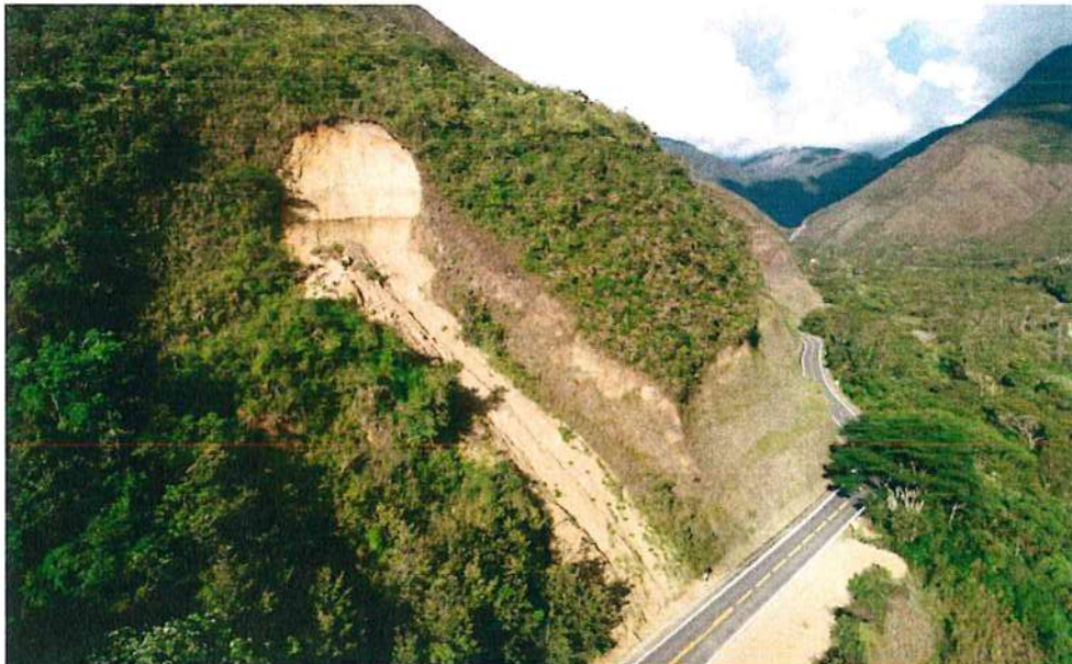
Fotografía 21. Derrumbes a la margen derecha de la carretera
