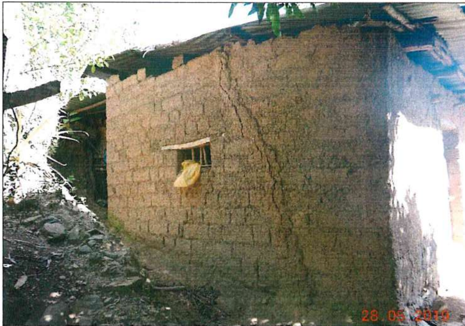
Fotografía 7. Vista de vivienda con pared agrietada en dirección N 291°.
