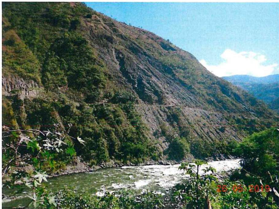
Fotografía 6. Derrumbes en tramo carrozable en construcción
