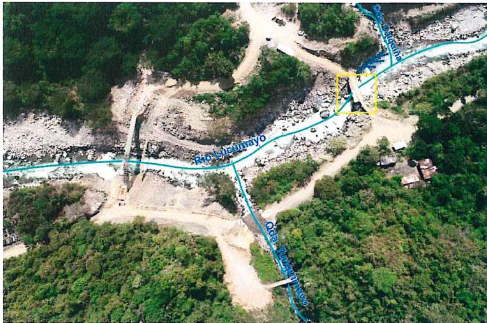
Figura 31. Puente Iyape y sus afluentes quebrada Tunquimayo y quebrada Calquiña afectados por flujo de detritos
