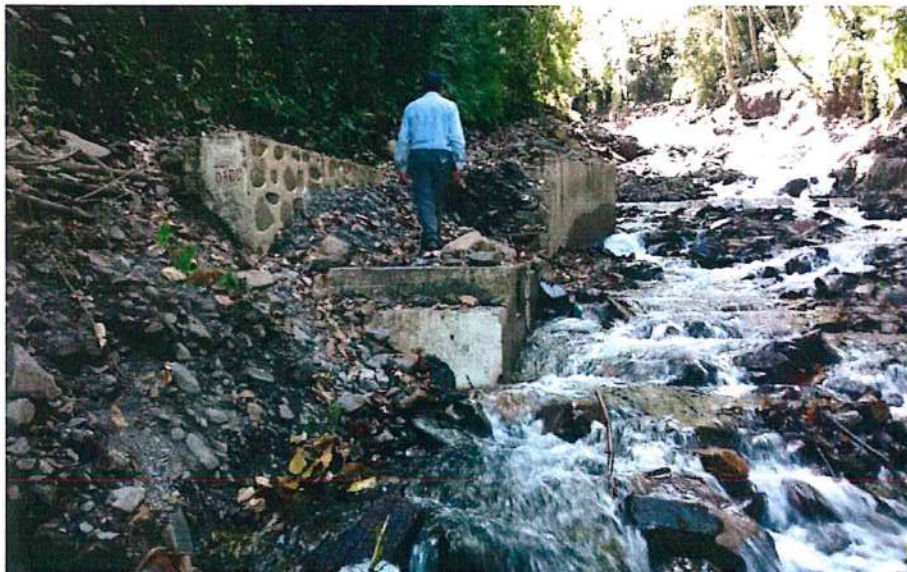
Fotografía 13. Se observa la captación de agua que colapsó a partir del flujo de detritos, detonado en noviembre del año 2018.
