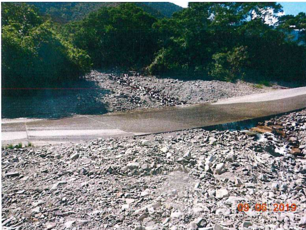
Fotografía 20. Badén afectado todos los años a partir de flujos de detritos, el cual obstruye el paso a la ciudad de Quillabamba.
