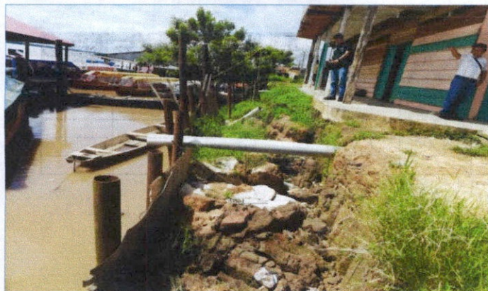
Sector con problemas de erosión y con presencia de pilotes de acero a modo de defensa ribereña, construido por pobladores.
