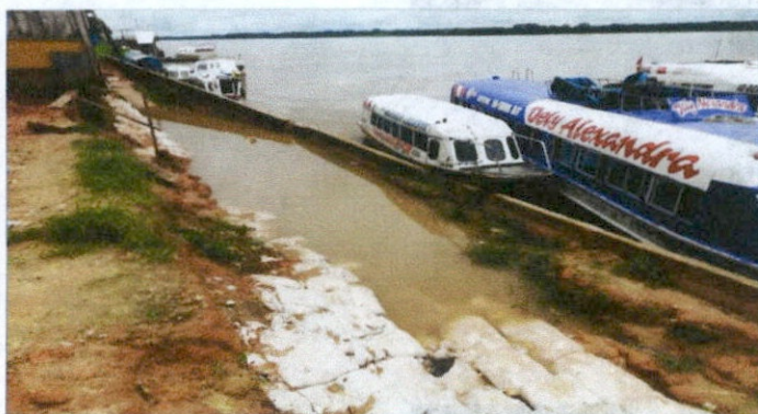
Sector inundado y erosionado, con presencia de pilas de sacos rellenos de tierra a modo de defensa - sector de la obra del boulevard
