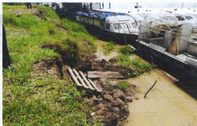
Ribera deteriorada por la erosión progresiva del río Marañón
