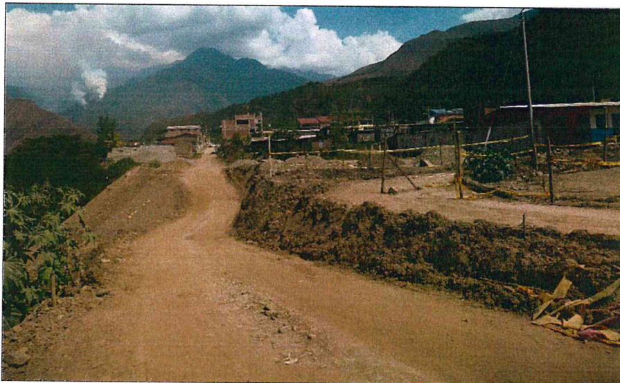
Fotografía 7: Vista del relleno que se viene realizando en el cuerpo del deslizamiento del 2013
