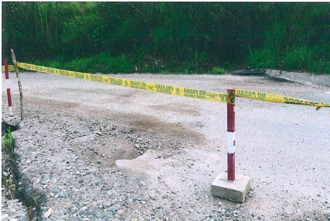
Foto 8. Carpeta asfáltica deformada y colapsada en la vía Puente Paucartambo – Villa Rica, al este de la zona de reubicación.
