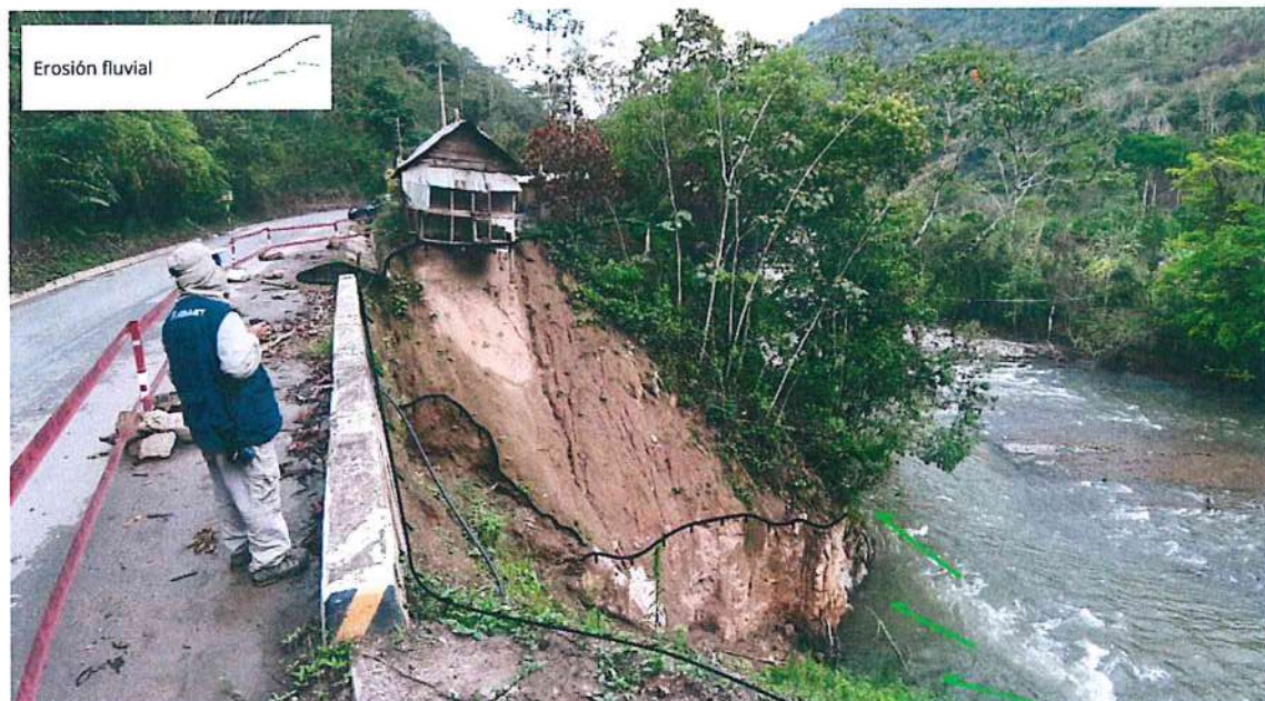
Figura 12. Erosión fluvial en la margen izquierda del río Paucartambo, colindante a la carretera Puente Paucartambo - Oxapampa.
