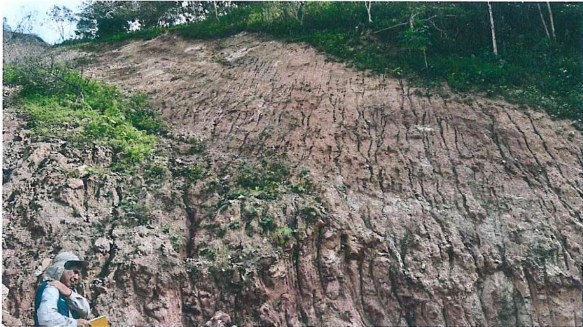
Fotografía 5. Erosión de laderas en el flanco izquierdo del deslizamiento.
