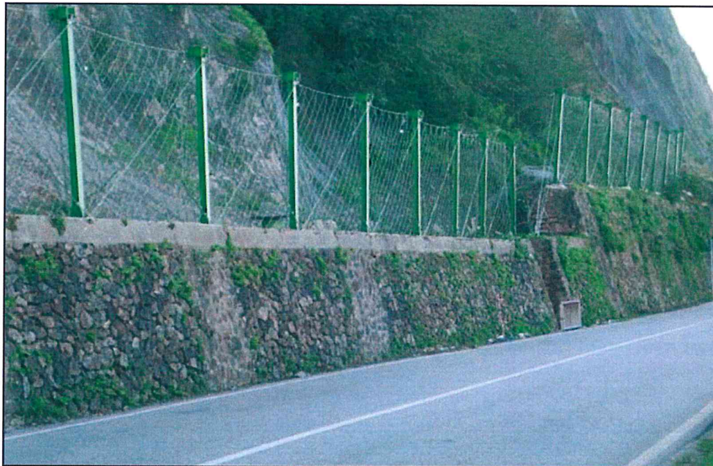
Figura 12. Ejemplo de mallas dinámicas para caída de rocas.
