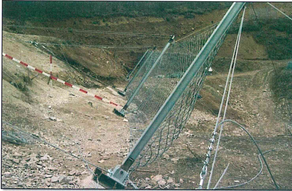
Figura 13. Ejemplo de mallas dinámicas para caída de rocas.
