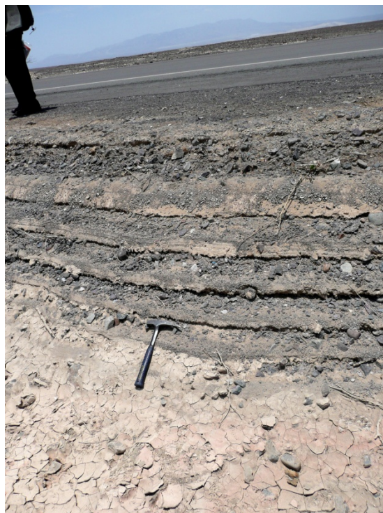
Fig. 16: Desnivel de la Panamericana Sur con respecto al nivel original del suelo. Se aprecia las distintas marcas de altura que alcanzaron el flujo en esta zona, esto se hubiera podido prevenir con un adecuado sistema de evacuación de flujos.
