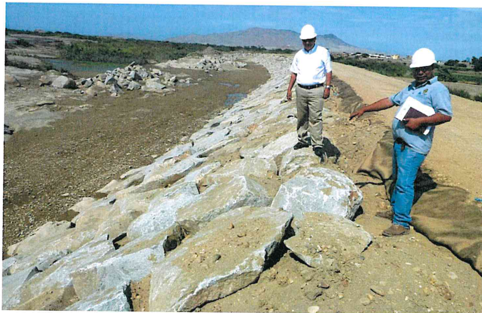
Imagen 01: Protección - dique enrocado acomodado
