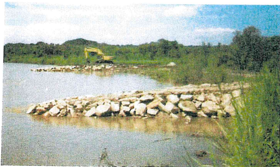
Imagen N° 5 Protección con espigones de roca
