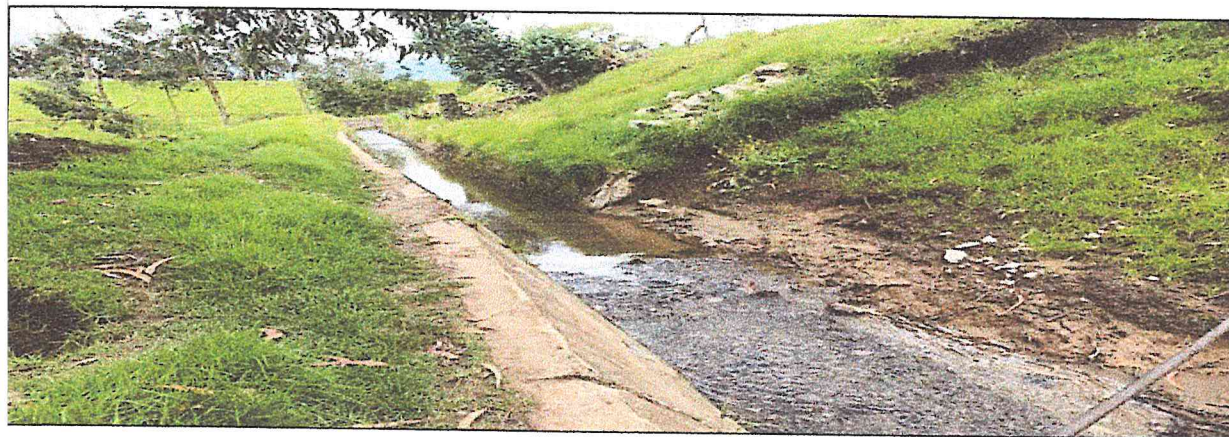
Fotografía N°03: Tramo colmatado del Canal Nancho.
