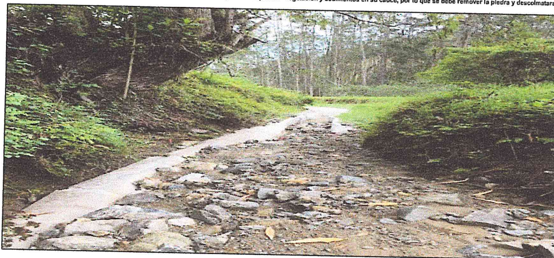
Fotografía N°03: Canal Cataluco colmatado, a donde podemos apreciar vegetación y sedimentos en su cauce, por lo que se debe remover la piedra y descolmatare.
