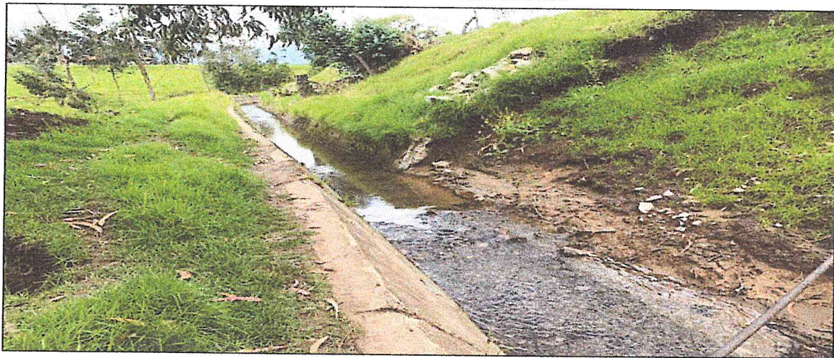
Fotografía N°03: Tramo colmatado del Canal Nancho.
