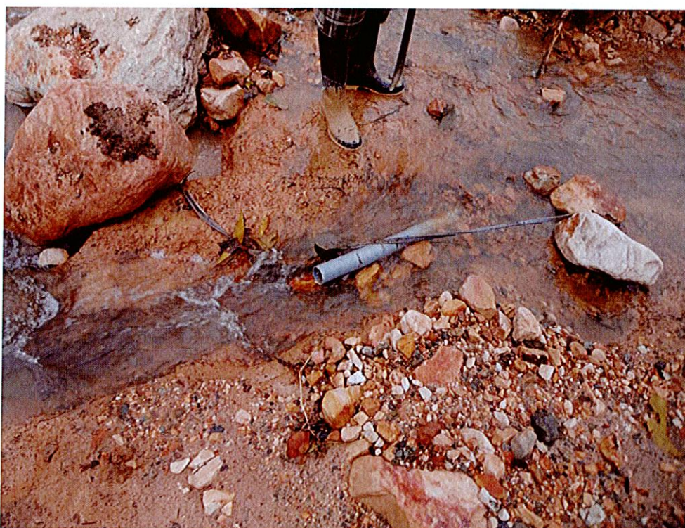
Foto 41. Restos de tubería de agua para agua potable, destruida parcialmente.
