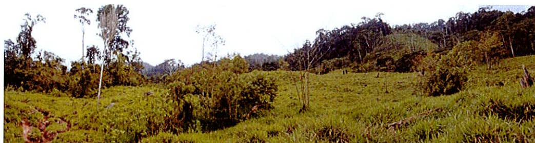
Foto 4. Ladera ondulada en la margen izquierda de la quebrada Umazapa, que constituye parte del cuerpo de un deslizamiento antiguo.
