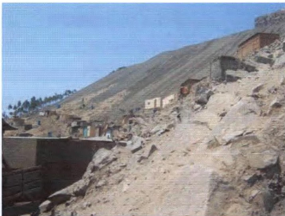
Foto N° 9 Se puede observar los conos de talus o canchales producto de la cantera que se encuentra en la parte superior.
