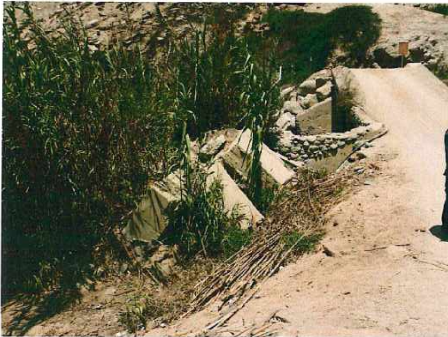
Fotografía N°11. Lado derecho del puente de acceso al poblado de Mandahuaz, donde se observa una antigua estación meteorológica del SENAMHI completamente destruida por el huaico del 2017, los equipos fueron retirados y actualmente se encuentran inoperativa.
