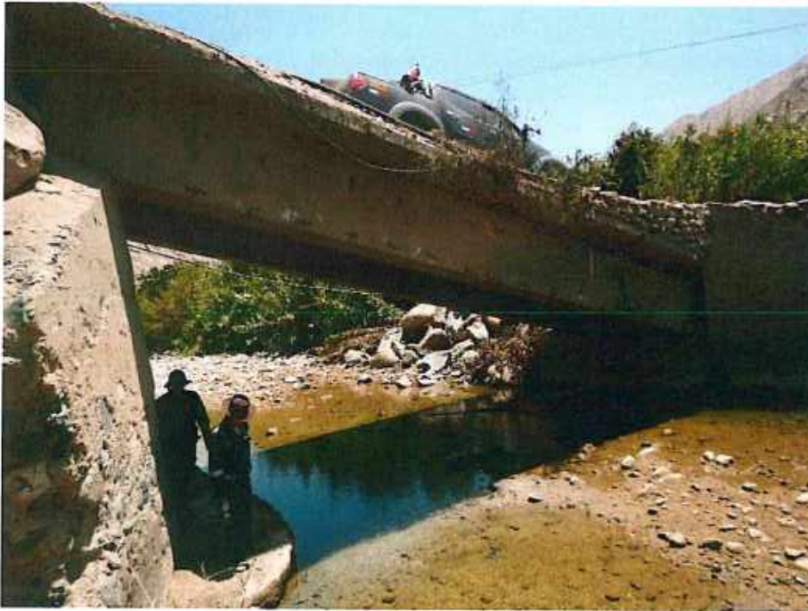
Fotografía 12. Muestra el estado actual del puente de Malvado (Única vía de acceso), obsérvese el estribo destruido (derecho) por el impacto del huaico del 2017.
