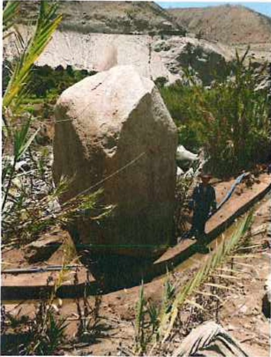
Fotografía 8. Se observa un bloque caído de una ladera escarpada, que cayó sobre una manga de riego en el sector de Malvado (Y: 212033, X: 8856910).
