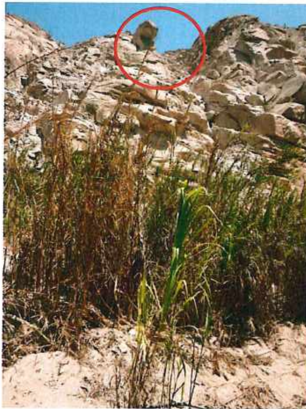
Figura 19. Se observa un bloque de roca (ancho: 4m aprox., longitud: 3m aprox., altura:3m aprox. propenso a caer en el sector de Malvado
