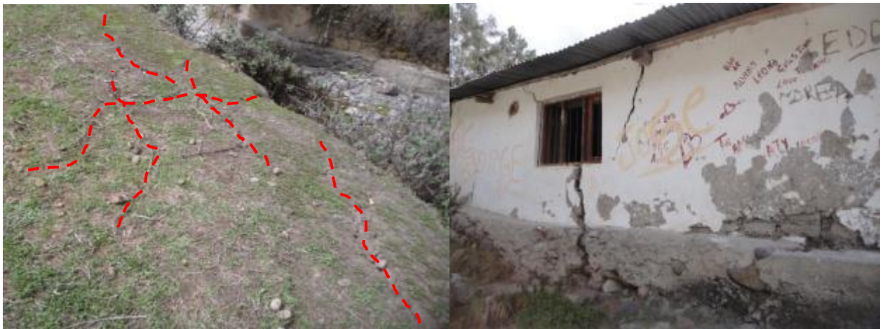
Foto 31: Vista de la zona afectada por reptación de suelos en la margen izquierda de la quebrada Shapil. En el lado izquierdo grietas muy cerca al cauce de la quebrada. En la vista derecha una vivienda afectada por agrietamientos producto del empuje de suelos.
