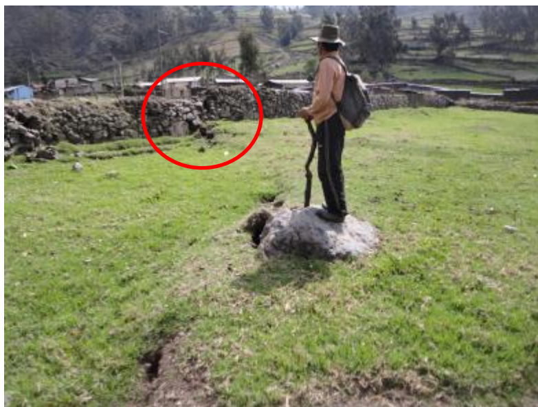
Foto 14: En la vista se aprecia el asentamiento de 60 cm, nótese detalle en el cerco de piedra.
