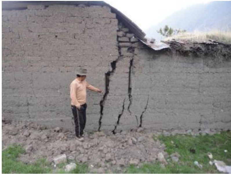
Foto 18: Presencia de grietas en la pared externa de la vivienda del lote 07, manzana 12, propiedad de la Sra. Peregrina Vega.
