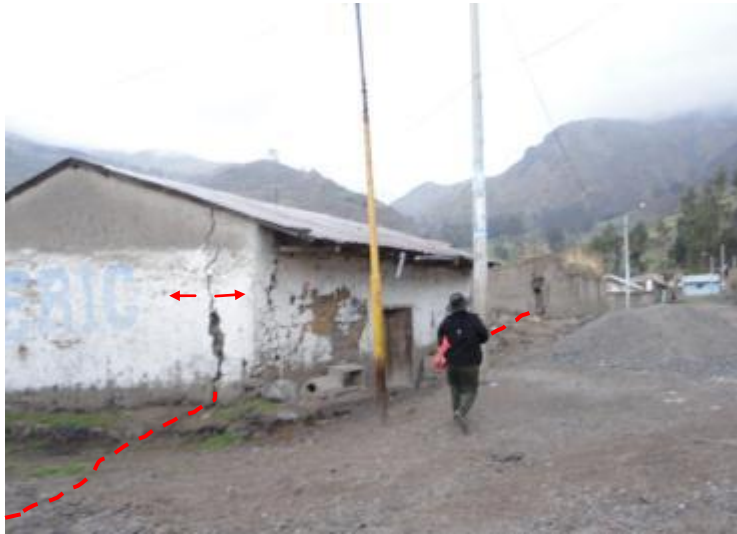
Foto 19: A lo largo de la calle, se hace evidente la presencia de una grieta principal que atraviesa las viviendas, llegando a su mayor afectación en la esquina de la Calle Hipólito Unánue con Jr. Republica en el Templo de la Iglesia Adventista, afecta viviendas de los lotes 06, 07, 08, 09 y 10 de la manzana 12.
