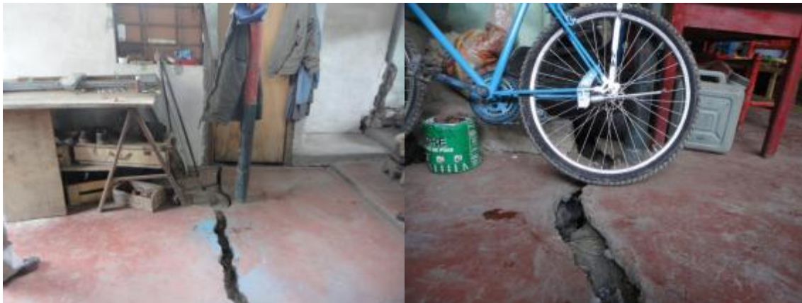
Foto 15: Vistas de grieta de 60 cm de profundidad y 12 cm de ancho, en el piso de la vivienda Lote 09, Manzana 12 de la comunidad Astobamba
