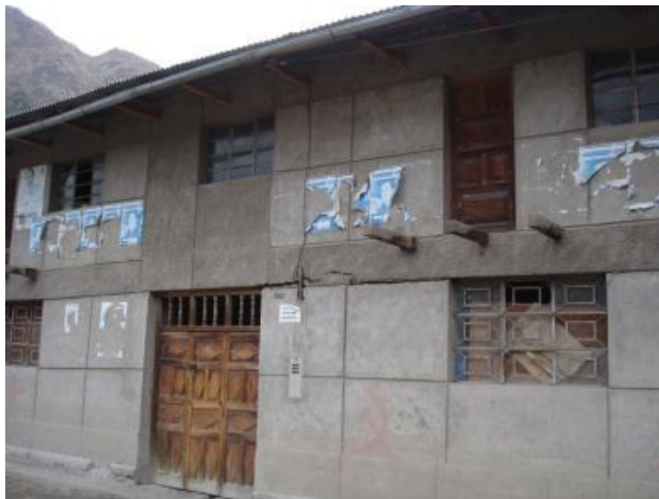
Foto 25: Fachada de la vivienda de la familia Fuentes Rivero, nótese el gran agrietamiento horizontal y el “descuadre” de la puerta principal. (Valderrama, 2008)
