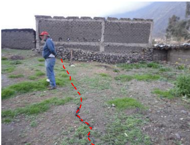
Foto 21: Asentamiento de 15 cm de profundidad, terreno escalonado, con presencia de grietas de 7 cm de ancho en la vivienda del lote 04, manzana 08, propiedad de la familia Castillo Soto.
