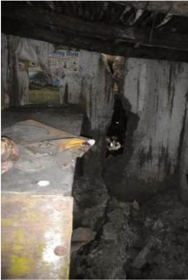
Foto 20: Grieta de 35 cm de ancho en las paredes, con presencia de asentamiento de aprox. 40 a 70 cm de profundidad en la vivienda del lote 05 manzana 09, propiedad del sr. Cirilo Arias Camacho.
