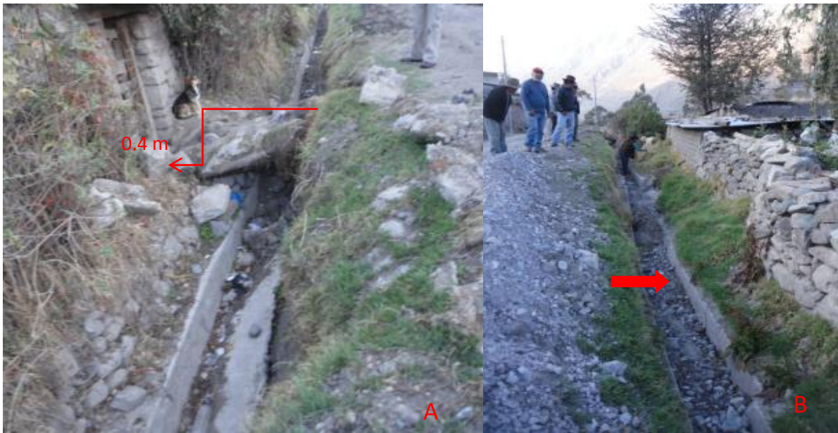
Foto 24: A) En la vista se aprecia el asentamiento aproximadamente de 40 cm de profundidad del canal y el pequeño puente rústico en el Jr. Belaunde. B) En esta vista se aprecia el desplazamiento horizontal del canal producto del empuje del suelo o terreno.
