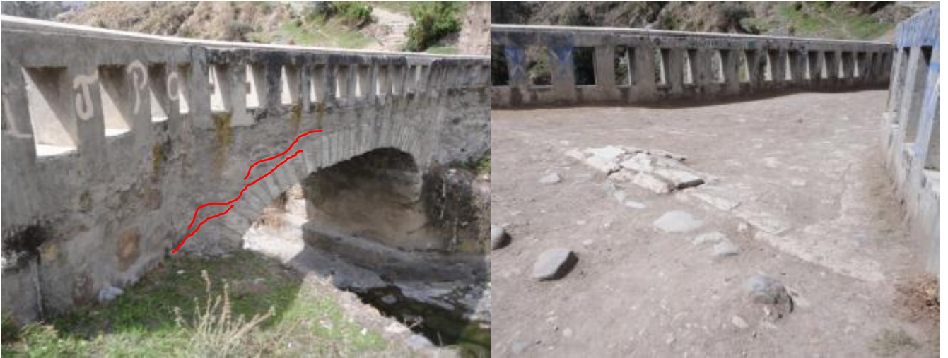
Foto 30: Vista del puente carrozable Cajatambo – Astobamba afectado por el flujo de tierra, nótese algunas grietas y asentamientos.
