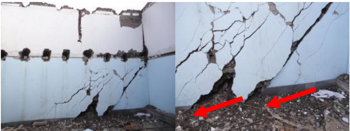
Foto 27: En esta vista se puede apreciar el sentido de dirección del empuje del suelo (arrastre), producto del flujo de tierra que afecta el sector
