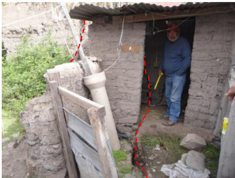
Foto 17: Presencia de grietas de 20 cm de profundidad y 10 cm de ancho, también presenta asentamiento en la vivienda del lote 07, manzana 12 de la comunidad Astobamba.
