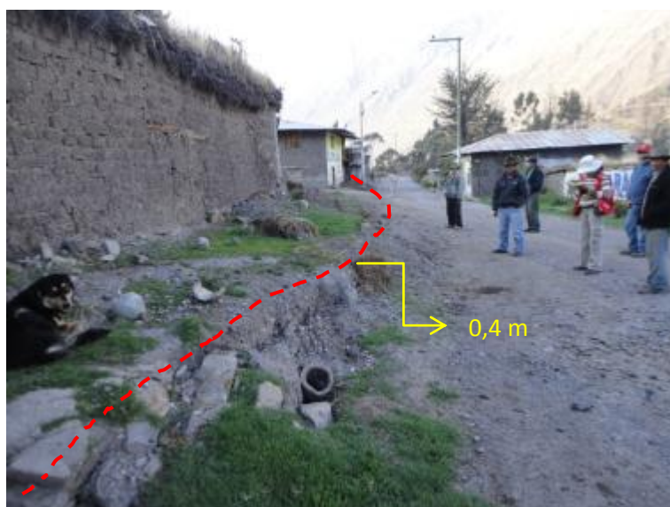
Foto 22: Asentamiento de aproximadamente 0,4 m en el Jr. Belaunde.
