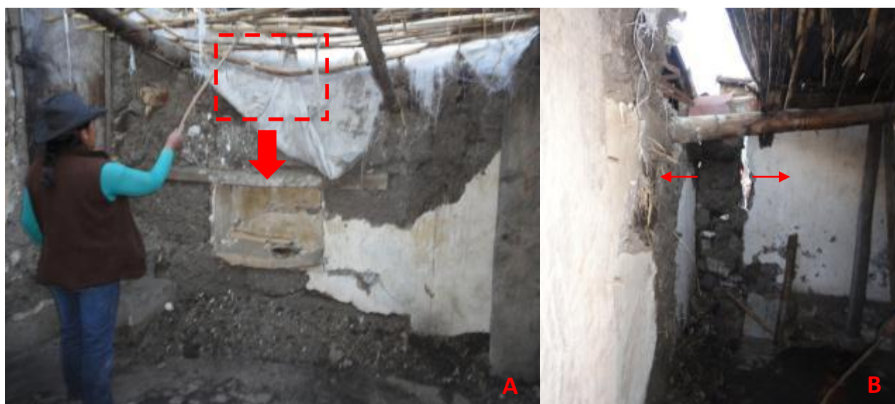
Foto 23: A) Asentamiento de la pared externa de la vivienda del lote 04, manzana 02, propiedad de la Sra. Alejandrina Quinteros: aquí funcionaba la panadería Milagros. B) En esta vista se puede apreciar la separación de las juntas de las paredes por una grieta de aprox. 0,4 m.
