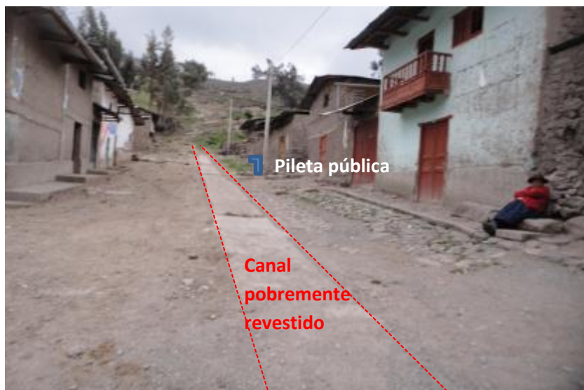
Foto 32: Canal pobremente revestido y mal uso de la pileta pública, son también factores que aceleran el proceso en la calle Ramón Castilla.
