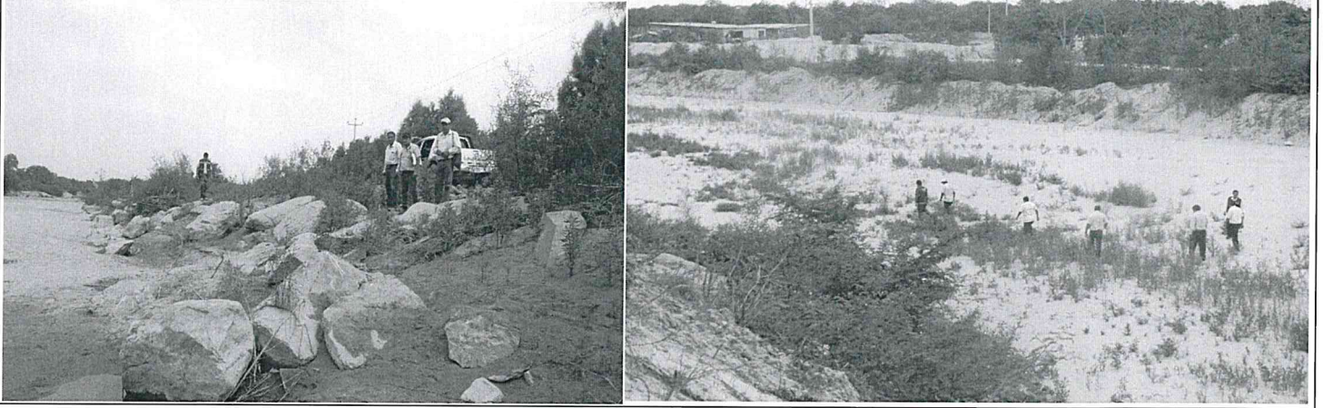
TRAMO CRÍTICOS EN LA MARGEN DERECHA DEL RÍO LA LECHE- LAS JUNTAS
