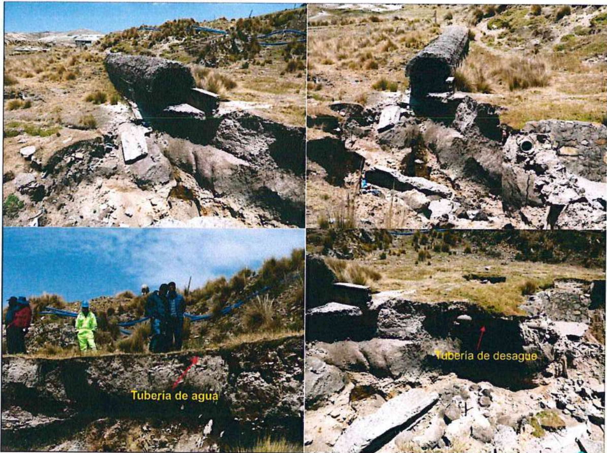
Figura 26: Es posible observar los daños causados en el canal pluvial cubierto de Wiscapuquio, así como en las tuberías de agua y desagüe que drenaban hacia la quebrada Chontacancha en la zona hundida.
