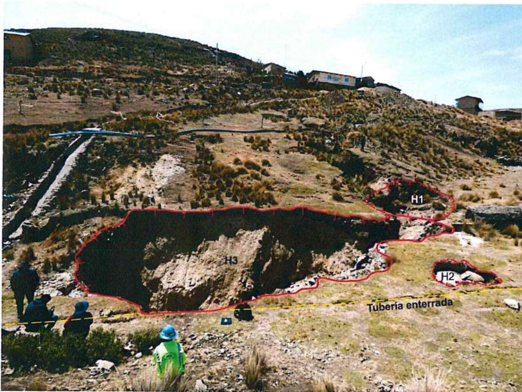
Figura 20: Vista con dirección al este donde se observa el hundimiento H3 en el cauce de la quebrada Chontacancha; también se señala otros hundimientos H1 y H2, así como la tubería enterrada que pasa por la margen izquierda de la quebrada.
