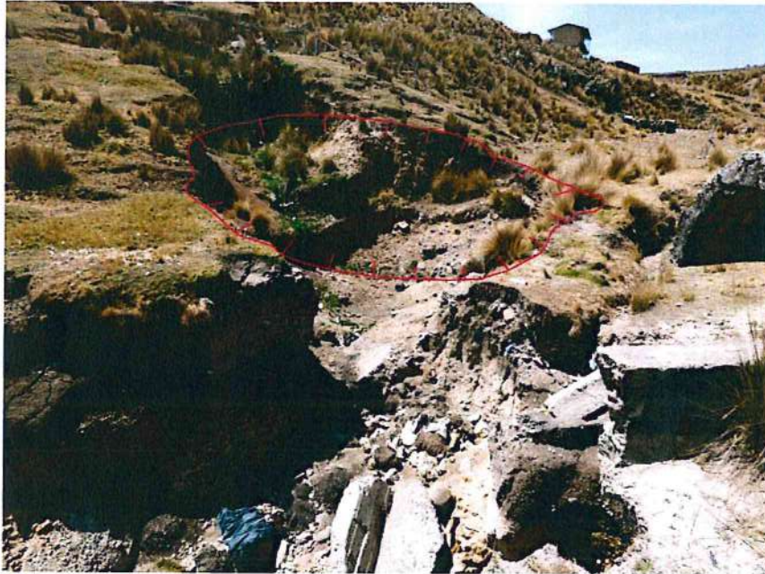
Figura 17: Vista con dirección al sureste donde se puede observar el hundimiento H1 (línea color rojo).
