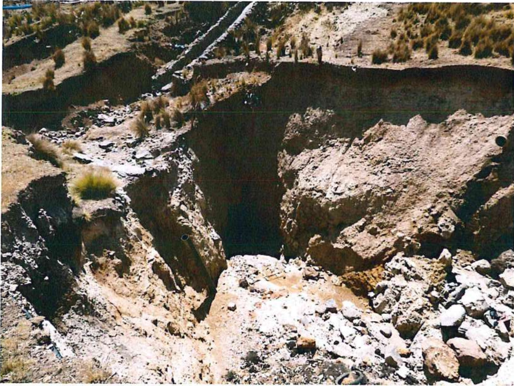
Figura 22: Vista con dirección al norte donde se observa la parte más profunda del hundimiento, cuyo fondo no pudo ser medido.
