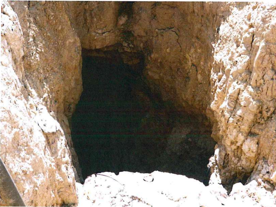
Figura 23: Vista en la que se puede ver la zona hundida más profunda, se observa las paredes verticales conformadas por calizas de la Formación Chambara; se puede observar también el fracturamiento y el estado de la roca moderadamente meteorizada, con coloración amarillo a anaranjado.
