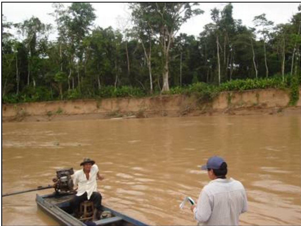
Foto N° 04. Margen derecha del Río Acre a la altura de Muro de Contención de la Av. León Velarde. Se observa la erosión y el desplazamiento de la ribera del Río (Formación F).
