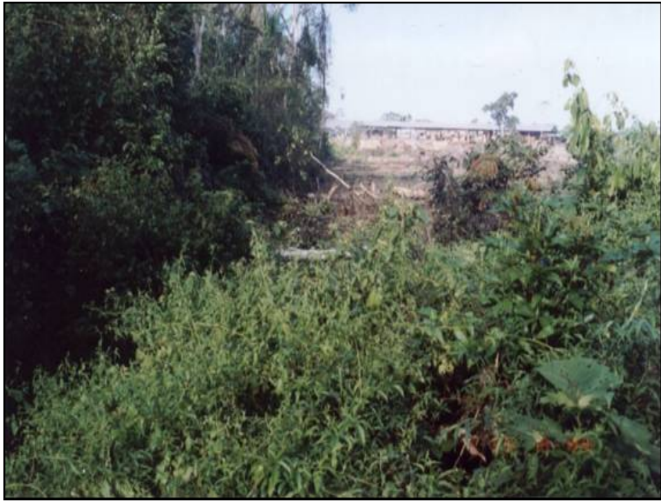
Foto N° 09. Se observa la Zanja de drenaje superficial, con falta de mantenimiento, totalmente colmatada, en la dirección de la Av. Bernardo Cardozo, al lado Sureste de la Ciudad de Iñapari.
