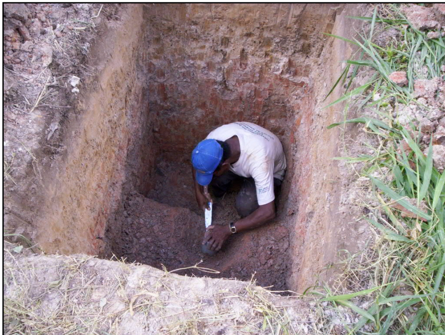
Foto N° 14. Vista general de los trabajos de toma de muestra inalterada de suelos, en la Calicata C7 ubicada en la zona Oeste del Jr. Bernardo Cardozo.
