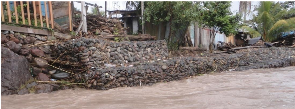
Foto 54: Defensas rivereñas conformadas por enrocado y gavión, afectada por el socavamiento del río.
