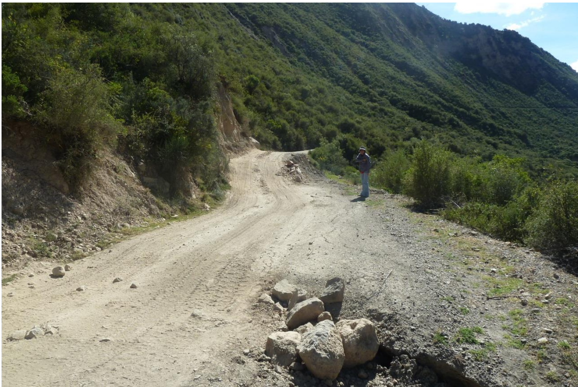
Foto 27: Reactivación que produce el asentamiento de la plataforma de carretera, con saltos de hasta 1 m.
