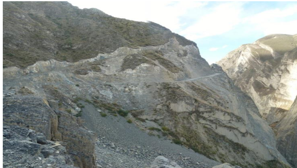
Foto 28: Talud de Carretera Pomabamba- Sarhua-Huancasancos intensamente fracturado, se producen derrumbes y caída de rocas.
