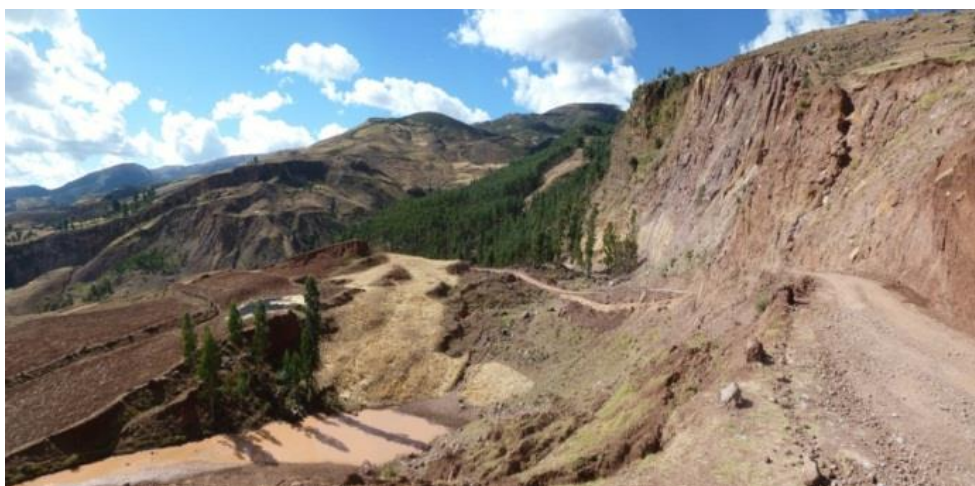
Foto 14: Vista lateral del deslizamiento en la quebrada Pamparque, es posible observar el asentamiento en la plataforma de carretera.
