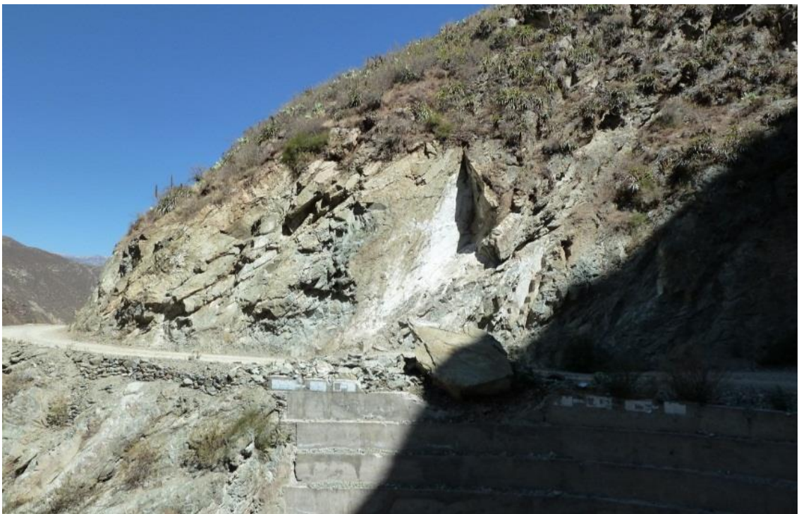
Foto 30: Bloque de roca desprendido desde talud superior de carretera por mecanismo de falla de cuña inversa, cayó sobre muro de contención.
