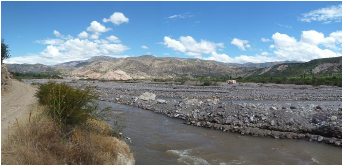
Foto 57: Vista donde es posible observar los efectos de la erosión fluvial hacia ambas márgenes del río Cachi, dejo una vivienda en medio del cauce.
