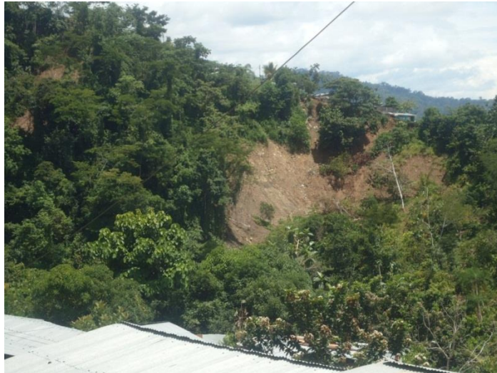
Foto 38: Ayna; sector del Mirador se observa viviendas en el borde de zona de derrumbe.
