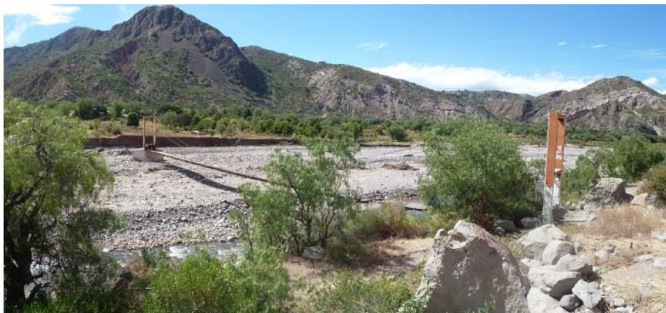
Foto 12: Puente peatonal en el sector de Pacaypampa, afectado por erosión fluvial en su estribo izquierdo, puente quedó colgado.
