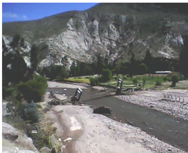
Foto 6: Puente peatonal que cruzaba el río Yucaes, con sus estribos inclinados por efectos del socavamiento de su base.
