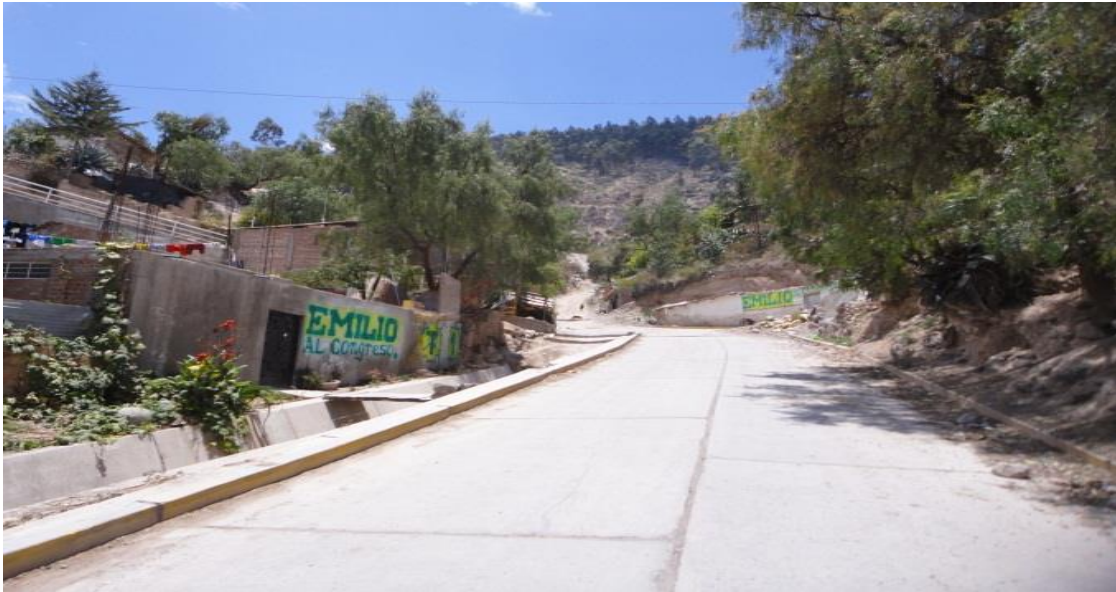
Foto 18: Torrenteras de huaycos en los alrededores de la ciudad de Ayacucho.
