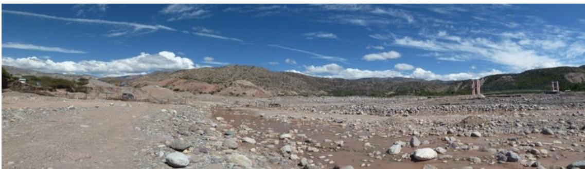
Foto 56: Puente vehicular que permite el acceso hacia Llamoctachi, quedo en medio del cauce del río Cachi, debido a la intensa erosión sufrida en ambas márgenes.
