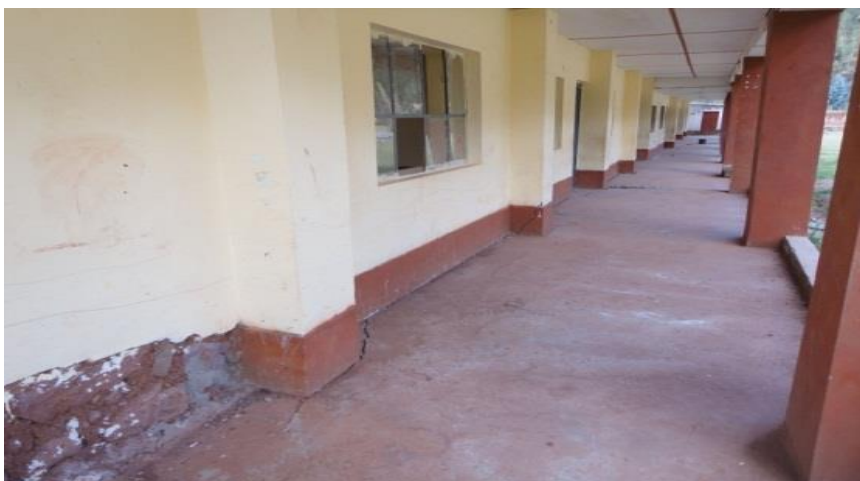
Foto 3: Grietas abiertas en pisos y paredes de centro educativo.
