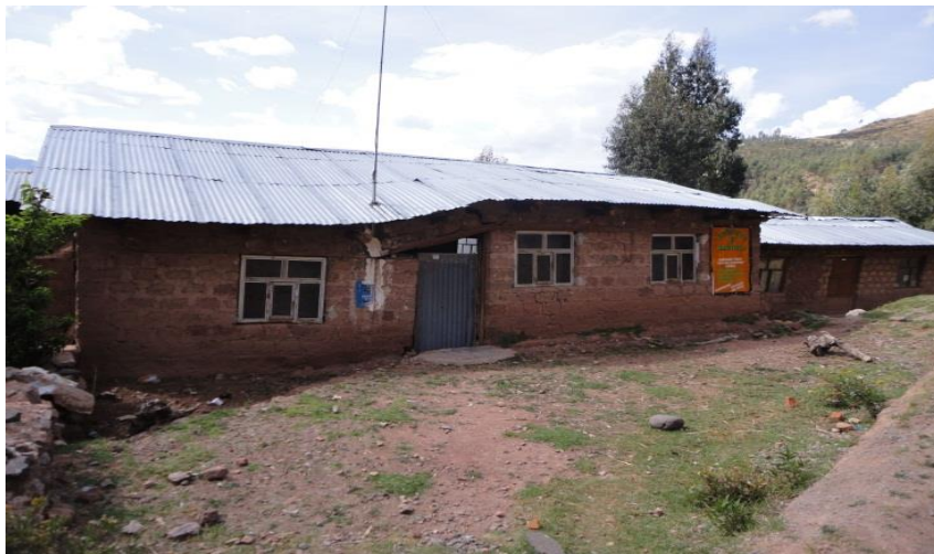
Foto 2: Agrietamiento y asentamiento de pared de vivienda por empuje de tierras.
