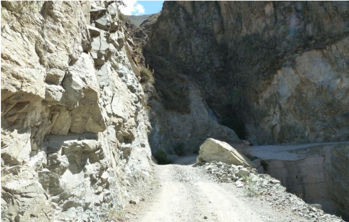
Fotos 29: Derrumbe de rocas y suelos en carretera Pacapausa- Ravacayco, compromete sustrato de rocas sedimentarias y volcano-sedimentarias.
