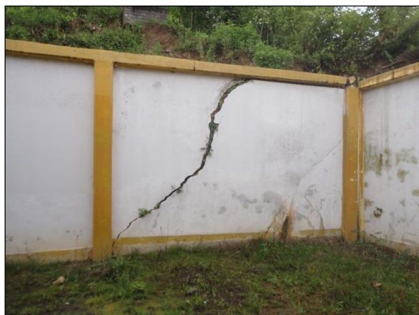
Foto 40: Rosario; grietas en paredes de centro médico.
