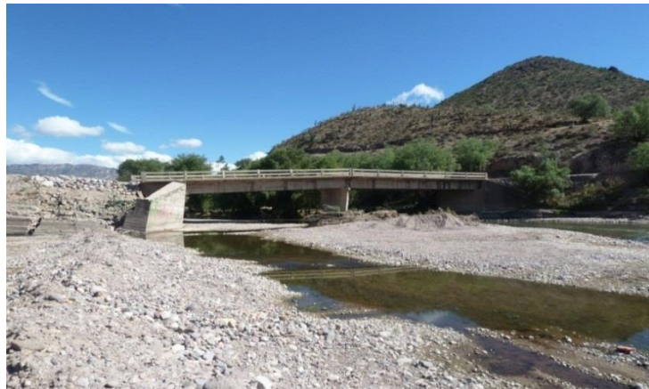
Foto 8: Sector Compañía, se observa puente vehicular que permite el paso hacia Julcamarca y Lircay, afectado por erosión fluvial en su estribo izquierdo.
