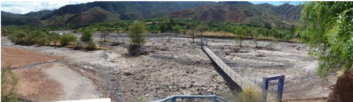
Foto 10: Puente peatonal que permite el acceso al poblado de Saccsacc, erosionado en su estribo izquierdo, el curso de río Cachi se movió hacia su margen izquierda, dejando al puente en medio del cauce.
