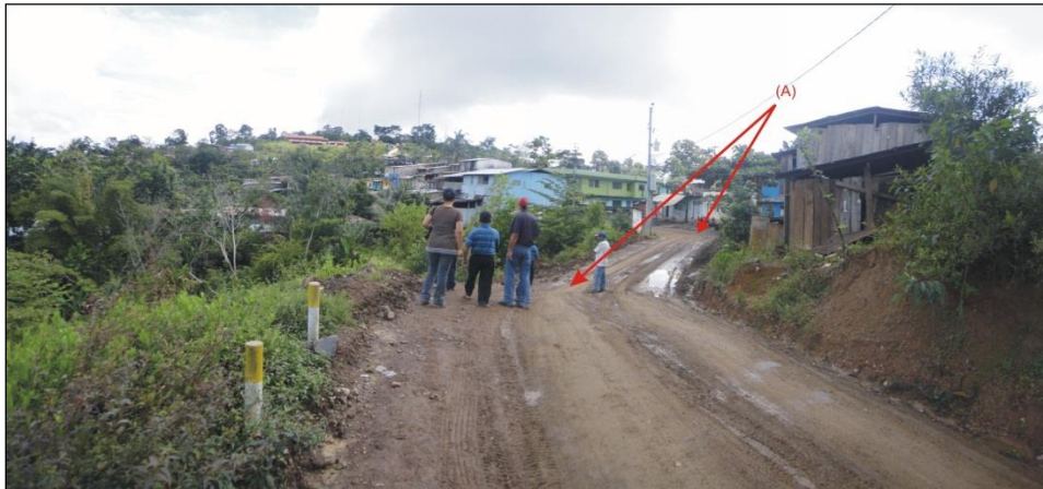
Foto 39: Rosario; carretera Ayacucho-Ayna con asentamientos producido por el deslizamiento.
