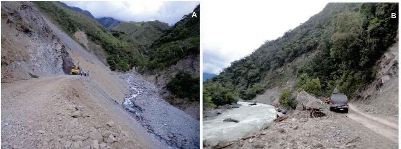
Foto 29: A) Derrumbe en talud superior de la carretera Tingo Mal Paso-Buena Vista, obstruyó aprox.300 m de la trocha carrozable de acceso a Buena Vista, en la margen derecha del río Blanco. B) Derrumbes en talud superior de la carretera Pozuzo-Tingo Mal Paso, altura del poblado Yanahuanca, margen derecha del río Santa Cruz, Km 7+500 afectado por sectores.
