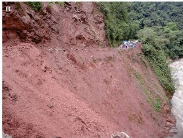
Foto 34: Derrumbe en el talud superior de la carretera Oxapampa-Pozuzo, en la margen derecha del río Pozuzo. Todos los años obstruye el paso vehicular, único acceso al poblado de Pozuzo desde Pasco (24/05/2011), sector Agua Salada.
