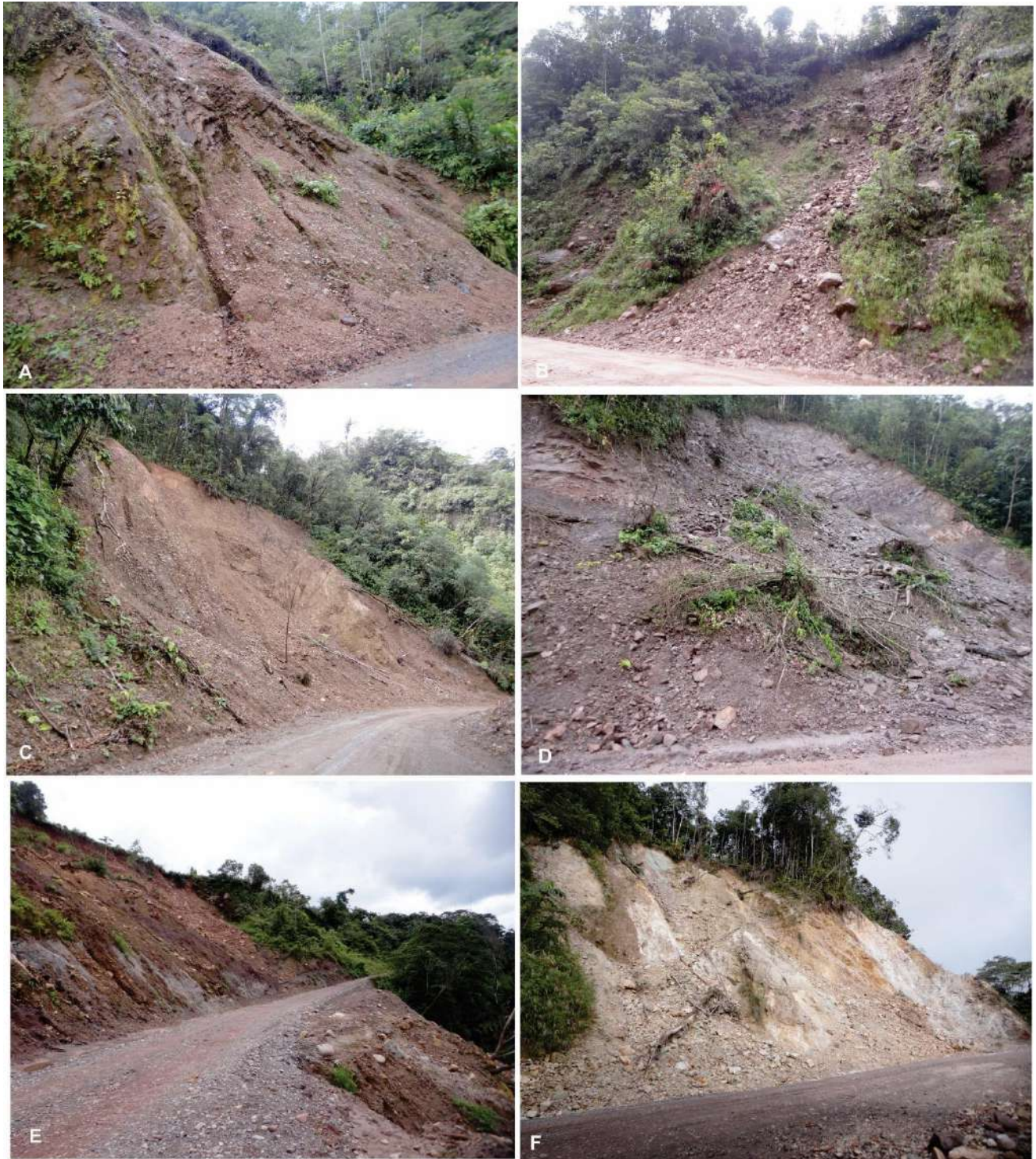
Foto 52: A) Derrumbe en talud superior de carretera Villa Rica-Puerto Bermúdez, en la margen derecha del río Cacazú. B) Derrumbes en el sector Santa Rosa de Pichanaz. C) Derrumbe en el talud superior que obstruyó 100 m de la carretera Villa Rica-Puerto Bermúdez, sector San Pedro de Pichanas. D) Derrumbe en el talud superior de la carretera Villa Rica-Puerto Bermúdez, de 40 m de alto. E) Derrumbes en el talud superior de la carretera a Puerto Bermúdez, sector Arroz con huevo. F) Derrumbe en la margen derecha de la quebrada Pichanaz.
