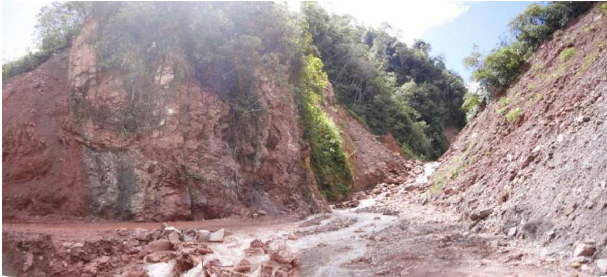
Foto 36: Huaico en la quebrada Agua Salada, también presenta derrumbes en ambas márgenes de la quebrada, afecta 100 m de la carretera a Huancabamba-Pozuzo.
