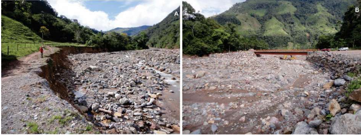
Foto 32: A) Erosión fluvial en la margen derecha del río Santa Rosa afecta tramo de 50 m de la trocha San Luis-San Cristóbal. B) Erosión en ambas márgenes del río Santa Rosa, se ha colocado enrocado en ambas márgenes para proteger estribos del puente Santa Rosa de 45.5 m de longitud.
