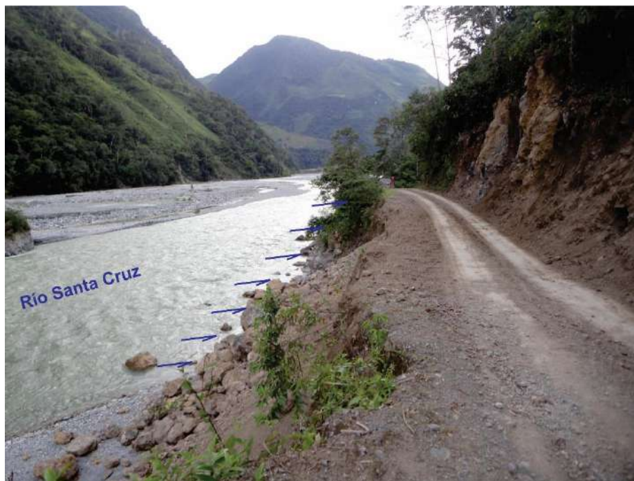
Foto 31: Erosión fluvial en la margen derecha del río Santa Cruz afecta aprox. 1200 m de carretera Pozuzo-Tingo Mal Paso.
