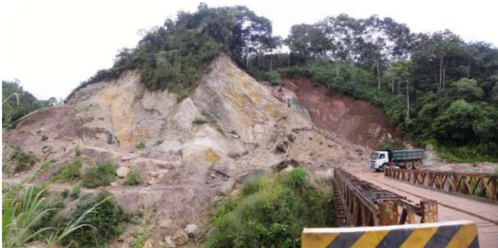
Foto 45: Derrumbes en margen izquierda de la quebrada Sal, en el talud superior de la carretera Desvío-Villa Rica, presenta erosión fluvial en ambas márgenes de los estribos del puente Quebrada Sal.
