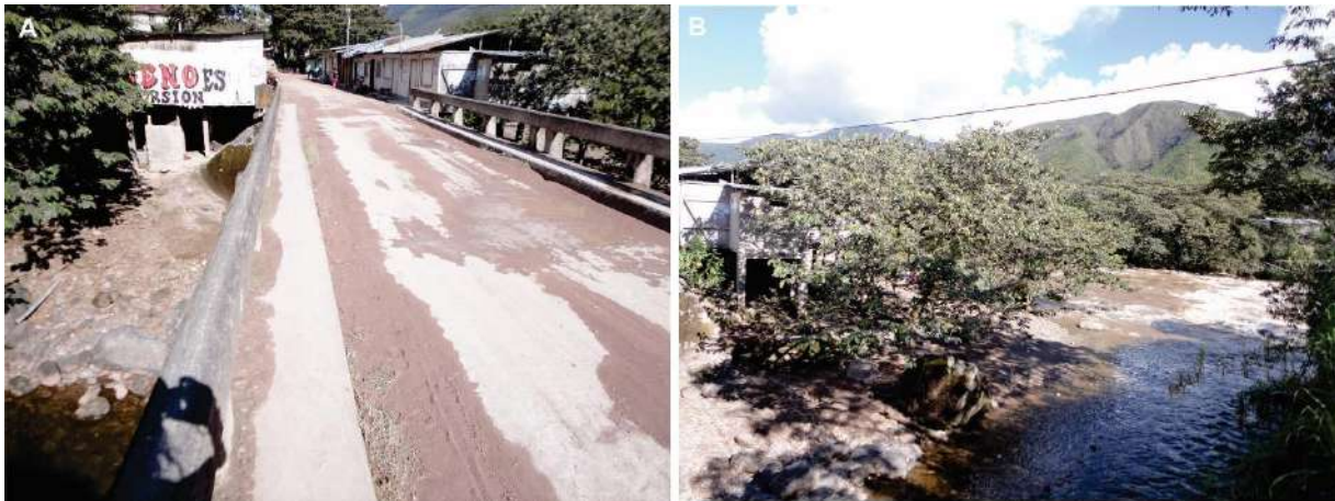
Foto 37: Inundación en margen izquierda de la quebrada Yanashara, Puente Huancabamba de 7 m de longitud por represamiento del río Chorobamba puede afectar 10 viviendas de Huancabamba.
