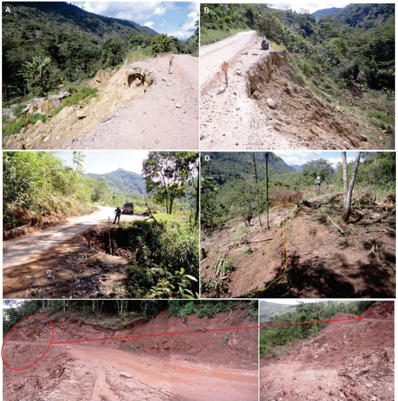
Foto 43: A y B) Deslizamiento en Pampa Encantada, destruyó una vivienda hace 2 años y parte de la carretera Puente Paucartambo - Villa Rica, margen derecha de la quebrada Sal, en la margen izquierda presenta derrumbes. C) Erosión en cárcavas en el Km 21+500 de la carretera desvío a Villa Rica, afecta por sectores la plataforma de carretera. D) Deslizamiento en talud inferior de carretera Desvío -Villa Rica, margen derecha de la quebrada Sal, a la altura del Km 21+600. E) Derrumbes en talud superior de carretera Puente Paucartambo - Villa Rica, Sector Ñangazú.
