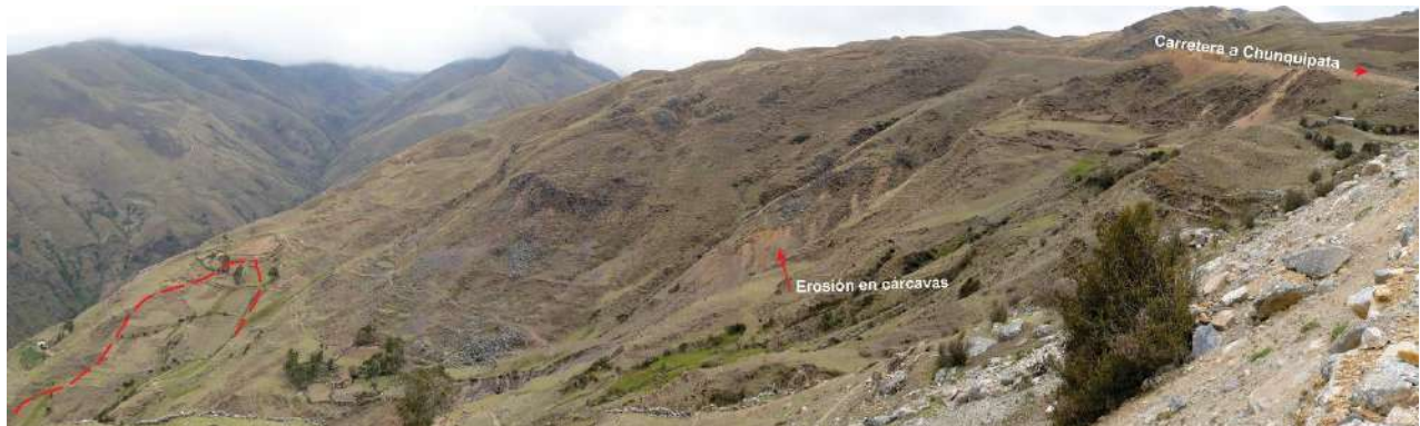
Foto 15: Vista de erosión en cárcavas y deslizamientos en el cerro Argoaro, la cárcava corta la carretera Pasco-Chunquipata que en época de lluvia genera huaicos interrumpiendo el tránsito vehicular.
