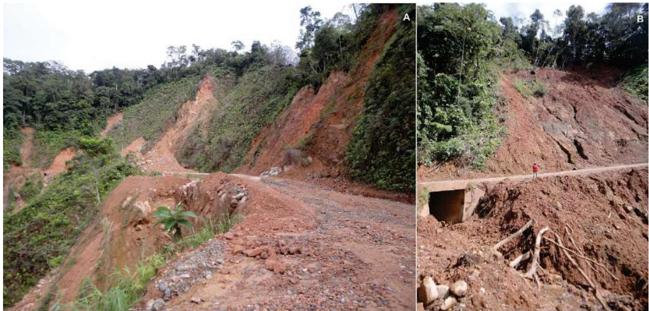
Foto 54: A) Derrumbes en el talud superior de la carretera de acceso a Puerto Bermúdez. B) Derrumbes en la margen derecha de la quebrada Huachirone.
