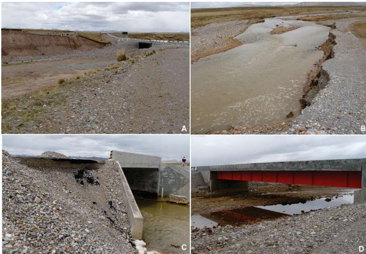
Foto 24: Erosión fluvial en los ríos Blanco, Colorado y San Juan, pueden afectar la carretera Cerro de Pasco-Huayllay, pontones y puente San Juan.
