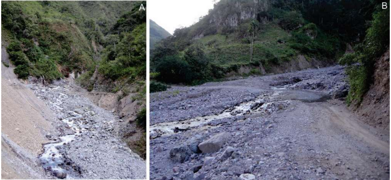
Foto 28: Vistas del río Blanco, todos los años se generan huaicos, en el año 2010 obstruyó el paso vehicular de la trocha carrozable Tingo Mal Paso-Buena Vista.
