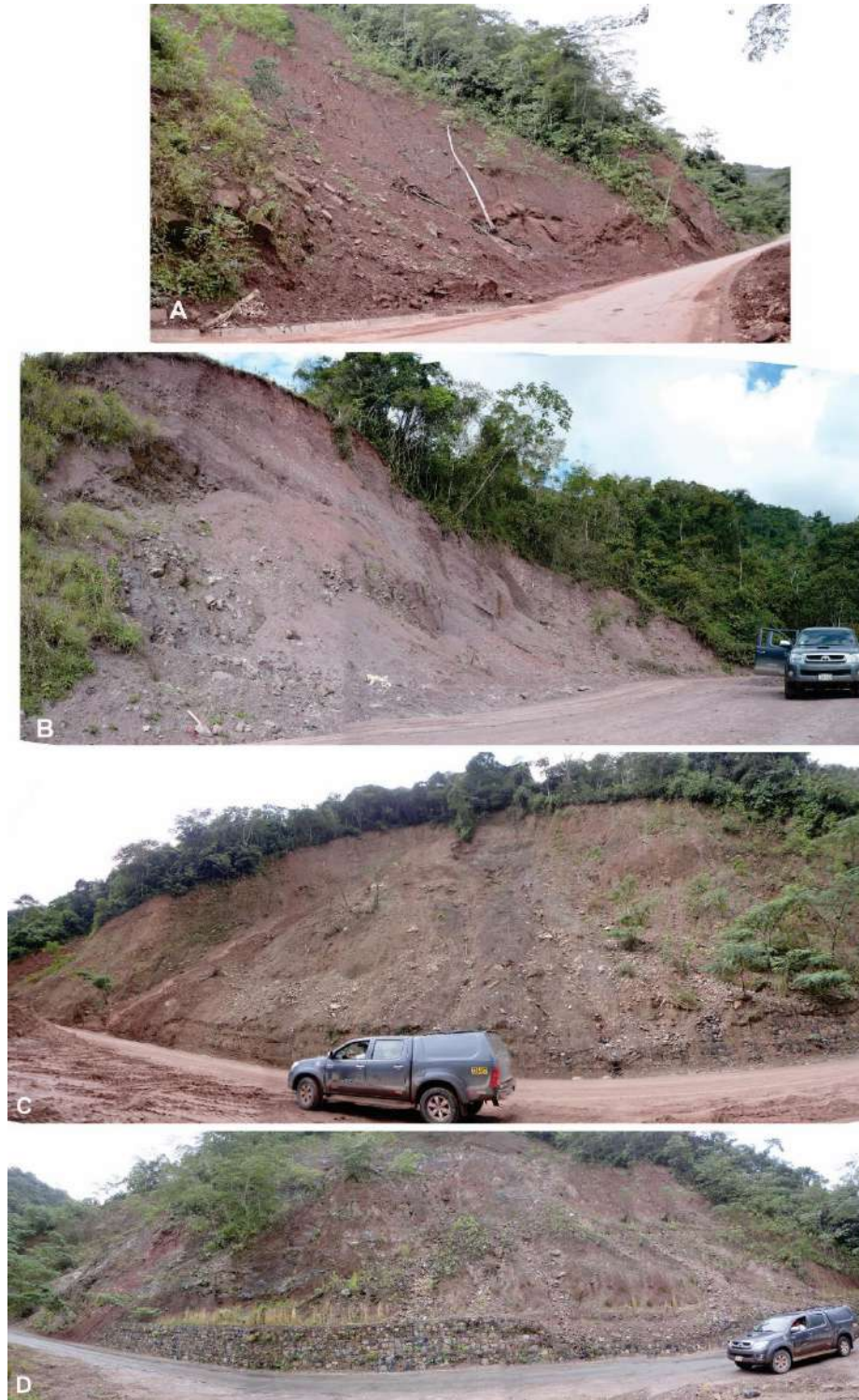
Foto 40: Derrumbes en talud superior de la carretera Puente Paucartambo – Oxapampa. A) Derrumbe en el Km 02+050, afecta 200 m de carretera. B) Derrumbes en el sector Churumazú, afectó cunetas y plataforma de carretera. C) Derrumbe en el Km 13+500 hasta el Km 13+100 por sectores, la carretera presenta asentamientos, afectó gaviones. D) Derrumbe en talud superior con presencia de asentamientos en la carretera, sector Churumazú afecta 250 m de carretera.
