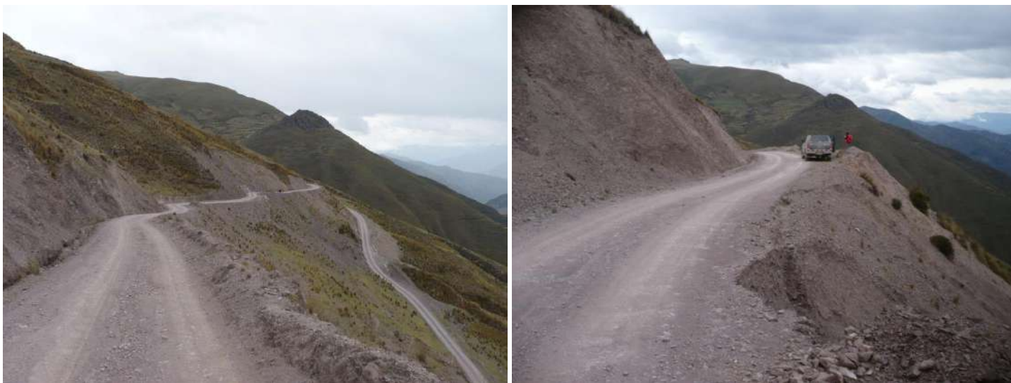
Foto 19: Sectores de la carretera Vinchos-Jarria- Pallanchacra, donde se observan los derrumbes en taludes superiores e inferiores de la carretera que afectan varios tramos en la margen izquierda del río Condoragra.
