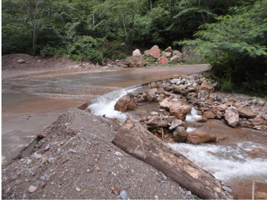
Foto 41: Huaico en la quebrada Tres Aguas se ha colocado badén y mampostería para proteger la plataforma de carretera Puente Paucartambo - Oxapampa, con presencia de bloques de hasta 1 m de diámetro en el cauce.
