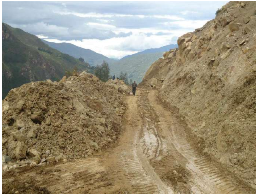
Foto 14: Derrumbe en talud superior de la carretera Santa Ana de Tusi-Pampania, en Febrero del 2012, interrumpió el tránsito de la carretera, específicamente en el tramo hacia el ingreso del Centro Poblado de Pampania. (Tomado de: http://diariocorreo.pe ).
