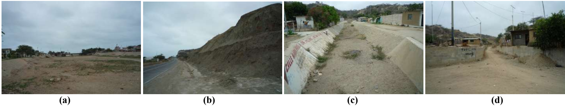
Panamericana Norte entre la Quebrada La Cruz y Zorritos. (a).- Quebrada LA Cruz por donde discurren flujos de lodo. (b).- Derrumbes en talud superior de la Panamericana Norte, sector cerro Loma Grande. (c).- Flujos de lodo excepcionales que discurren por torrenteras encauzadas, sector de Nueva Esperanza, a la altura del km 228+817 de la Panamericana Norte. flujos de lodo excepcionales en el poblado de Mechero Roci.
