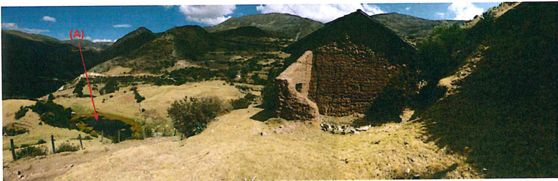
Foto 17: Vivienda afectada en el año 1985, por el empuje del terreno. En el lado izquierdo se aprecia una laguna (A).
