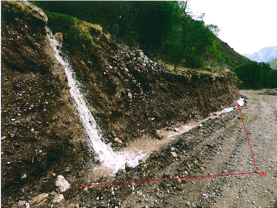
Foto 38: Cuneta de la carretera usada como canal de conducción del agua (A).
