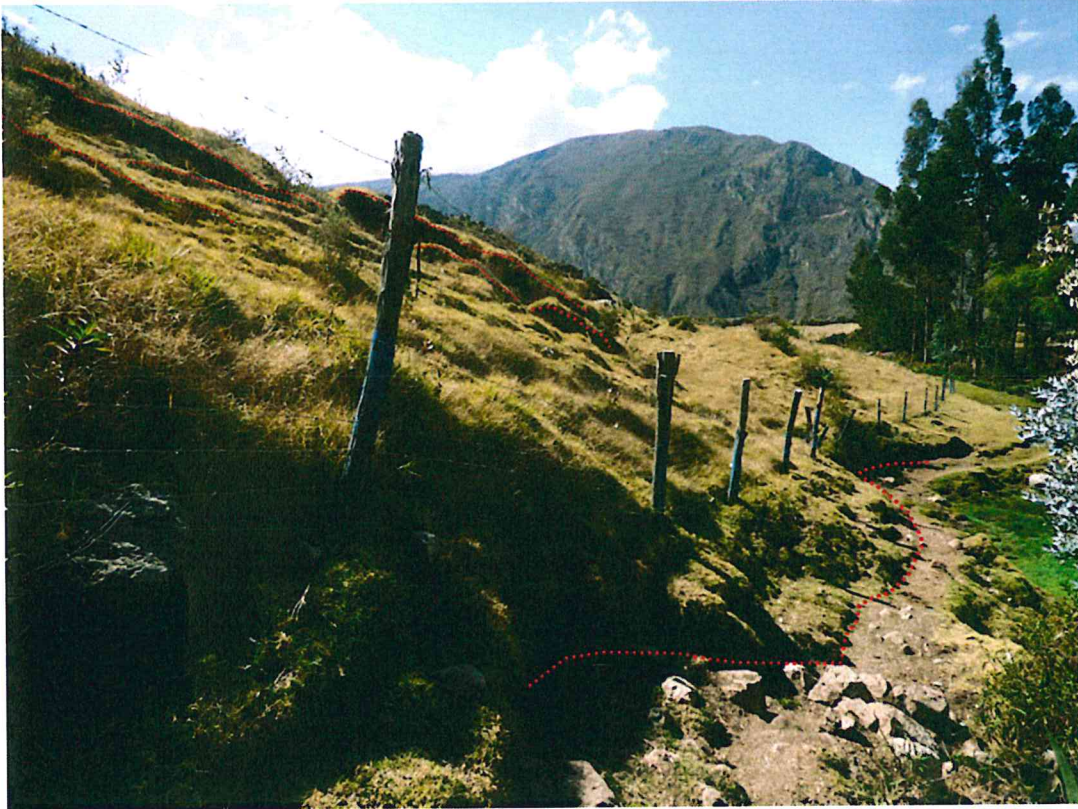
Foto 18: Se aprecian los saltos del deslizamiento, se observa el cerco perimétrico ligeramente inclinado por el empuje del terreno.
