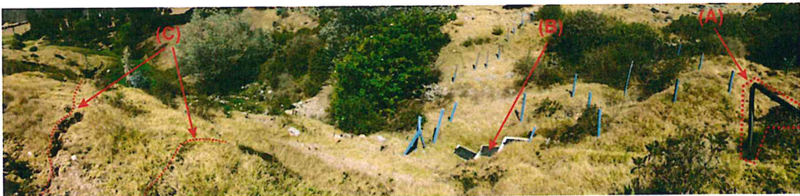
Foto 19: Tubería de agua levantada y colapsada (A), colector sin uso (B), y agrietamientos en el terreno (C).
