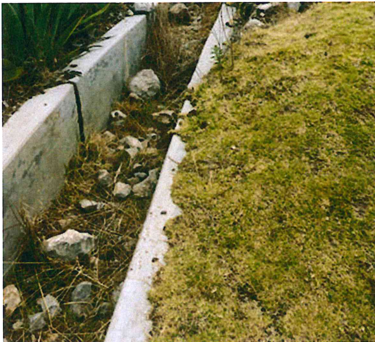
Foto 16: Canal de drenaje, abandonado por colapso.
