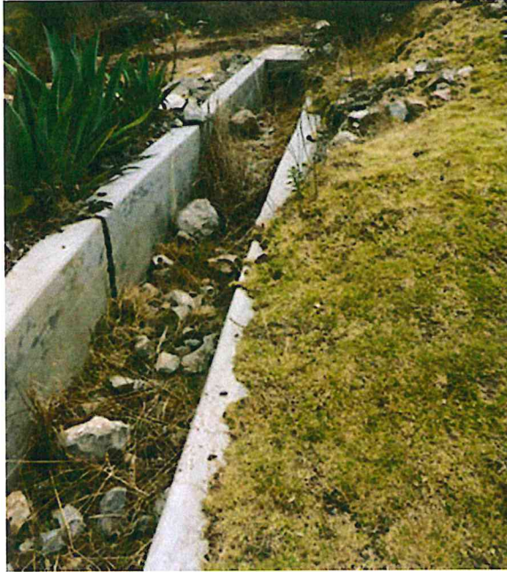
Foto 20: Canal de drenaje, afectado por el movimiento del terreno.
