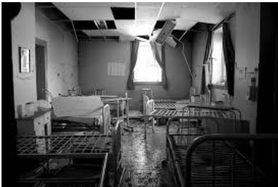
Figura 10. Luminarias no sujetadas adecuadamente en techo ante movimientos sismos, se caen e incrementan el peso del falso cielo raso provocando colapso de los sistemas.
