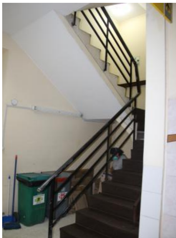
Figura 16. Escalera estrecha para la evacuación.
