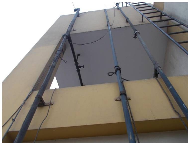
Figura 42. Tuberías de ingreso al reservorio elevado.
