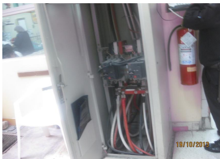
Figura 44. Instalaciones eléctricas expuestas pueden producir cortocircuitos.
