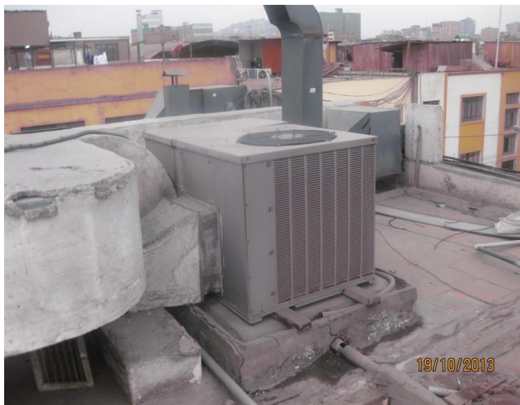
Figura 47. Equipo de aire acondicionado deteriorado y sin anclajes de sujeción.
