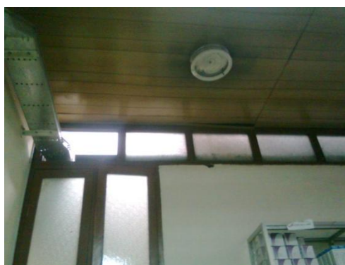
Figura 40. Pese al trabajo que se ha venido realizando en el Hospital, aun se pueden apreciar artefactos de iluminación sin la debida protección, contra pérdida o daño.
