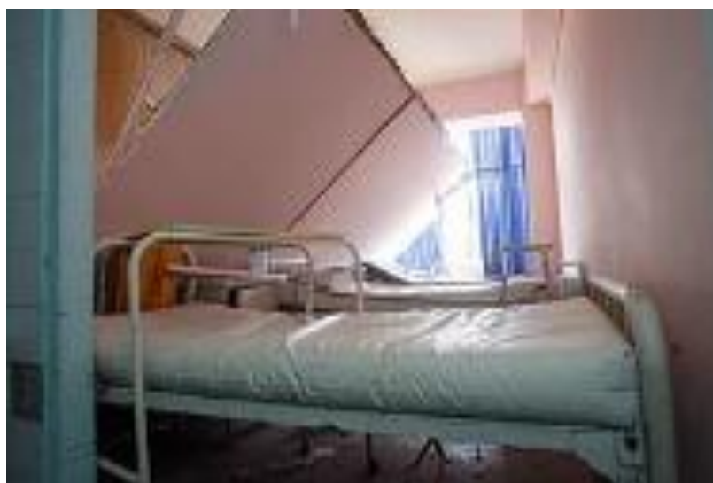
Figura 8. Tabiques no asegurados adecuadamente, corren el riesgo de deformaciones o caídas ante eventos adversos.
