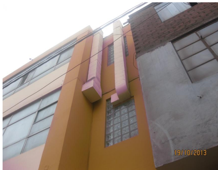
Figura 46. Ductos de aire acondicionado sin soportes ni anclajes adecuados.
