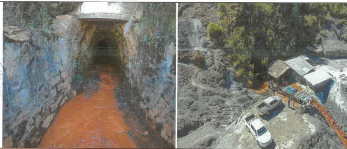
Imágenes N°9 y 10: Los lixiviados que drenan de las mineras artesanales abandonadas, no son tratadas y se encuentran contaminando fuentes de agua y el subsuelo. En la actualidad se están abriendo concesiones en Pomallucay.
