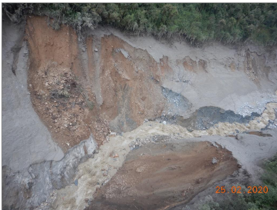
Fotografía 5. Zona de derrumbes producto de la dinámica erosiva que generó el aluvión.
