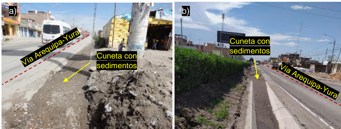
Figura 28. a y b) Muestran cunetas en márgenes de la vía Arequipa-Yura rellena de sedimentos.
