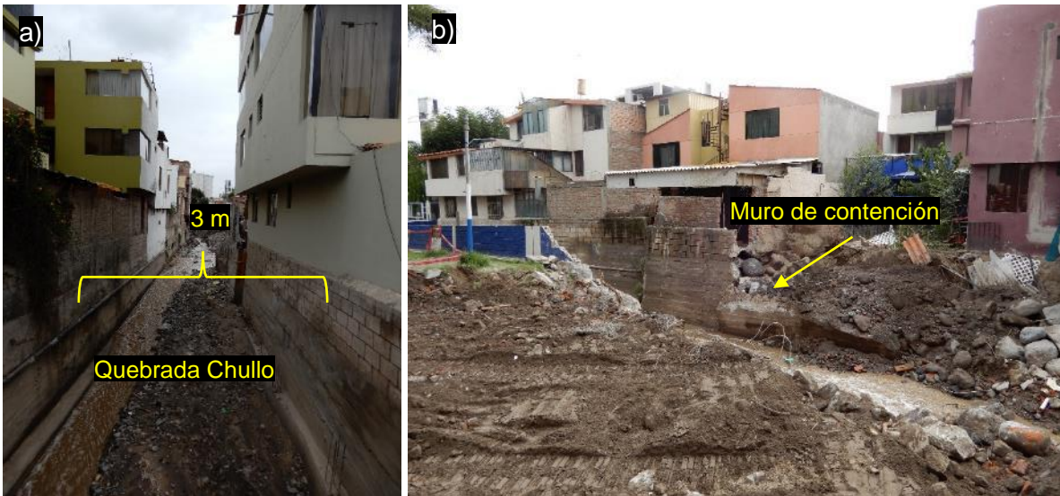
Figura 24. Sector Urbanización Independencia Americana, distrito Yanahuara. a) el cauce de la quebrada se estrangula a 3 m de ancho. b) muro de contención destruido.
