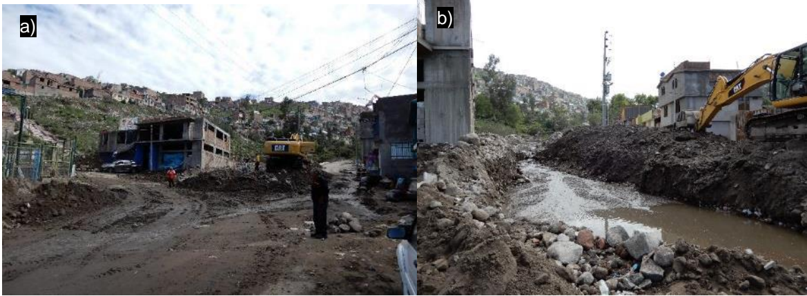
Figura 7 a y b. Trabajos de limpieza de la Municipalidad distrital de Paucarpata, en el sector Pozo Negro.
