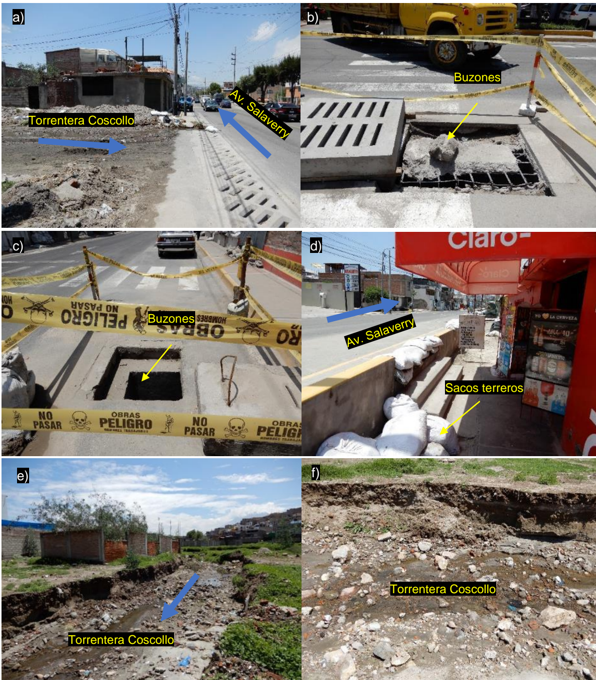
Figura 14. Sector Lara, distrito Socabaya. a) dirección de flujo del huaico hacia el sector Lara. b y c) buzones colmatados. d) viviendas que fueron inundadas por el huaico b) material de escombro y basura en la quebrada Coscollo.
