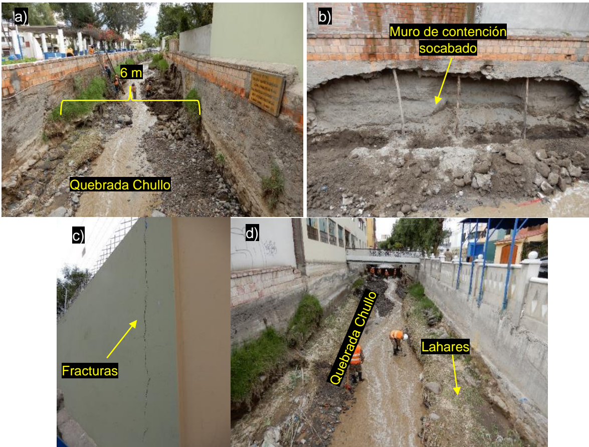
Figura 23. Sector Puente Primavera, distrito Yanahuara. a) muro de contención antiguo y debilitado por la erosión de los huaicos. b) pared socavada por los huaicos. c) fracturas en las paredes de las casas a causa de los asentamientos producidos por la socavación en el lecho de la quebrada. d) depósitos de lahares dentro de la quebrada.
