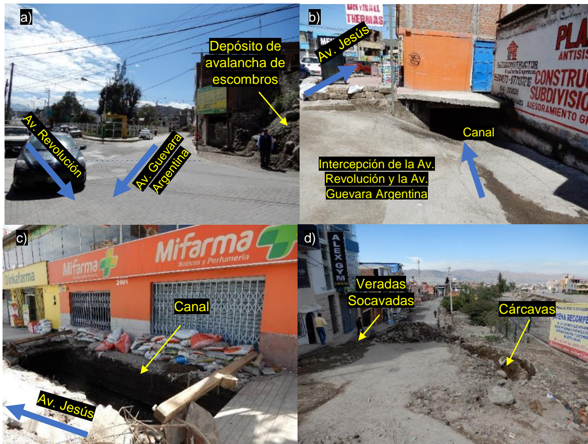
Figura 12. Sector Baden, distrito de Paucarpata. a) dirección de flujo del huaico desde la Av. Revolución y la Av. Guevara Argentina hasta el sector de Baden. b) canal angosto por donde ingresó el huaico. c) canal colapsado, impidió el tránsito peatonal e inundó farmacias y casas. c) cárcavas en suelos limo-arenosos de la Av. Malecón Arica.
