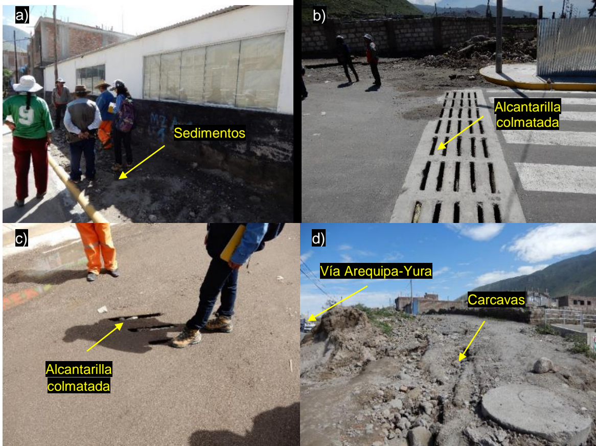
Figura 29. Muestra el sector Monserrat afectada por los huaicos del 25 de febrero. a) vereda de una vivienda con sedimentos y fragmentos de roca. b) drenaje colmatado con sedimentos, agua y basura. c) cubierta superior del drenaje cubierto por los sedimentos que dejó el flujo. d) surcos y cárcavas en zonas colindantes a la carretera Arequipa-Yura.
