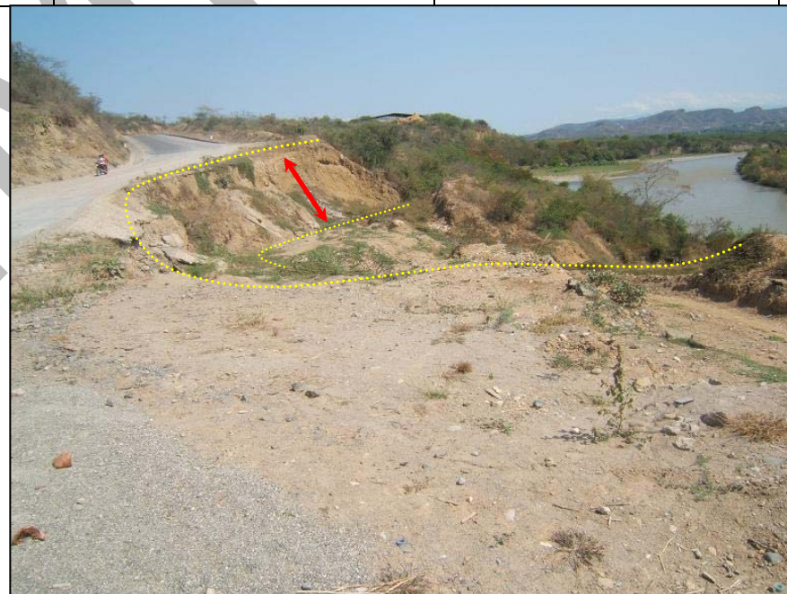
Plataforma de la carretera Fernando Belaunde Terry, sector San Luis afectado por deslizamiento.
