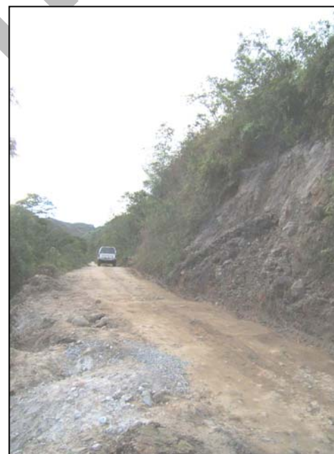
Talud de corte para carretera donde se producen derrumbes, material compuesto por depósitos de pie de monte.
