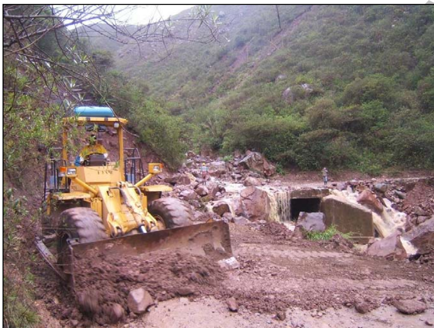
Cauce de la quebrada Rondón colmatado por flujos o huaycos, interrumpe el tránsito por esta vía (Chachapoyas – Rodríguez de Mendoza).
