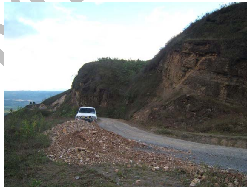
Zona de derrumbes y caídas de rocas en el sector de Hualamita.
