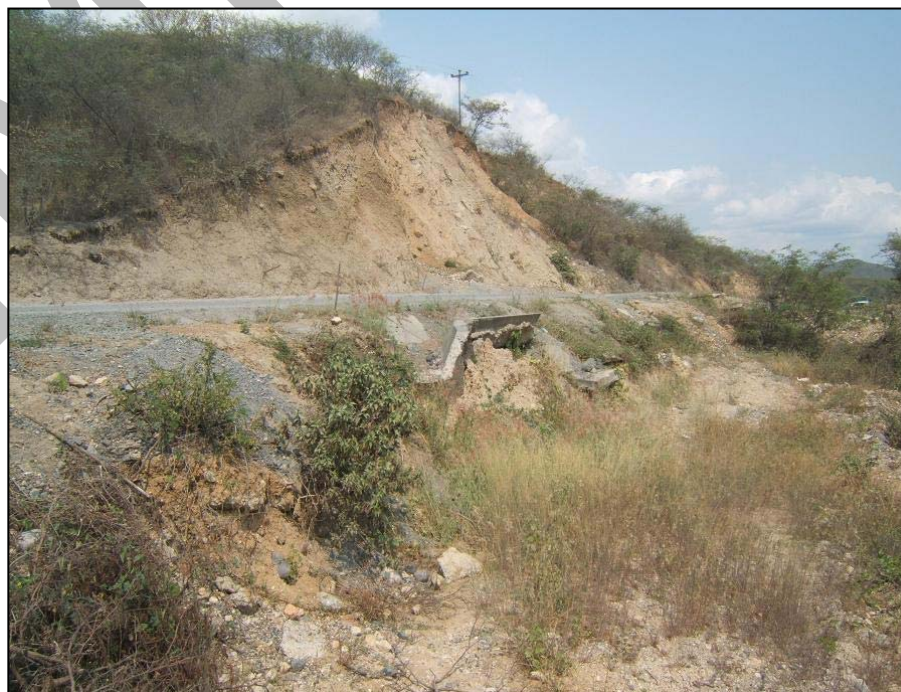
Santa Elena, Km 238. Talud inferior de carretera afectada por deslizamiento
