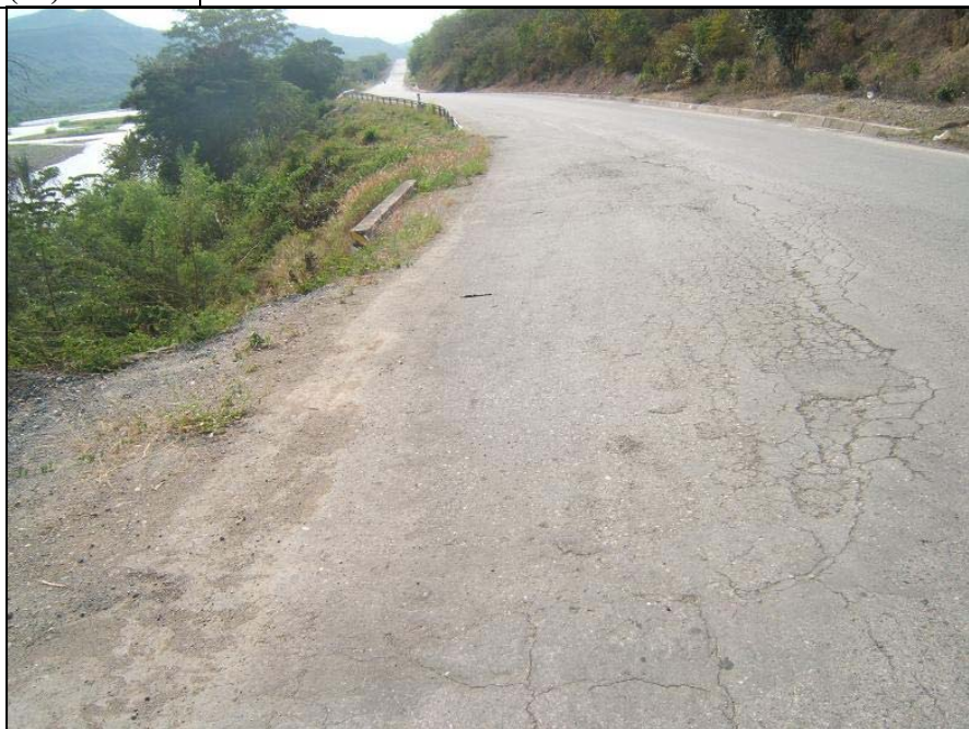
Plataforma de la carretera Fernando Belaunde Terry, tramo Toromocho – Nanñaco afectado por erosión fluvial.
