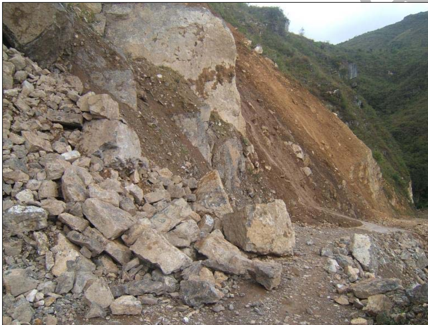
Derrumbes, caída de rocas y pequeños huaycos que afecta la carretera Maino – Levanto, margen derecha del río Osmal.
