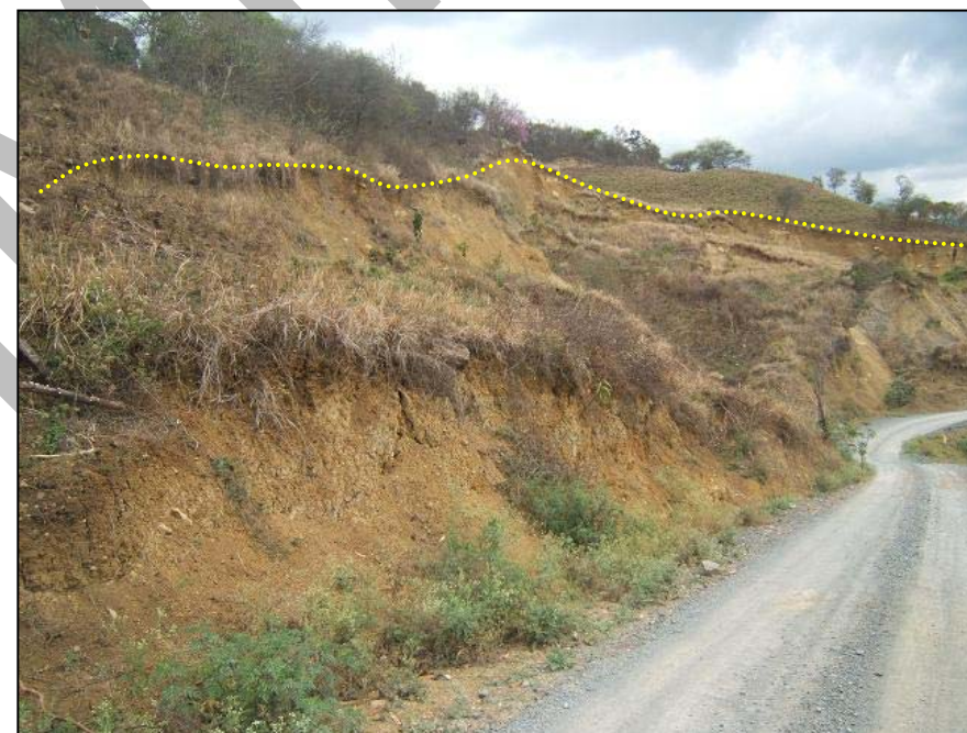
Escapa de deslizamiento rotacional activo, ubicado en la margen derecha de la quebrada Olón. Por el área cruza la carretera de acceso al distrito de Jamalca.
